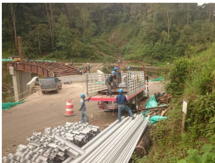
Figura 71. Descargue de la baranda del puente quebrada el oro Fuente: Pasante
