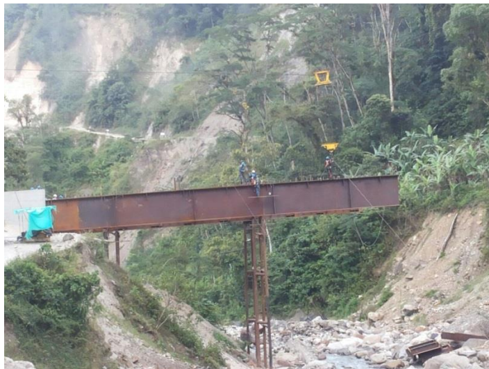
Figura 38. Vista panorámica de la estructura metálica del puente Quebrada el Oro Fuente: Pasante
