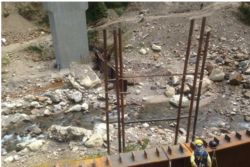
Figura 25. Instalación de los apoyos provisionales para la instalación de la estructura metálica
