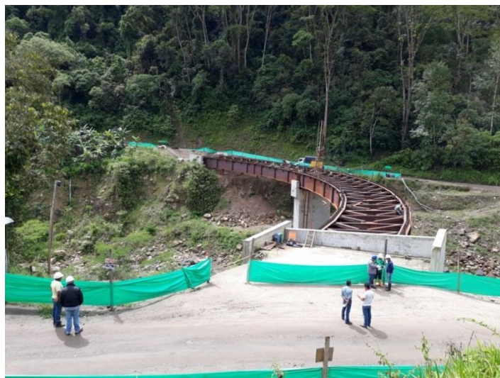
Figura 82. Vista panorámica desde el eje “A” del puente quebrada el oro Fuente: Pasante
