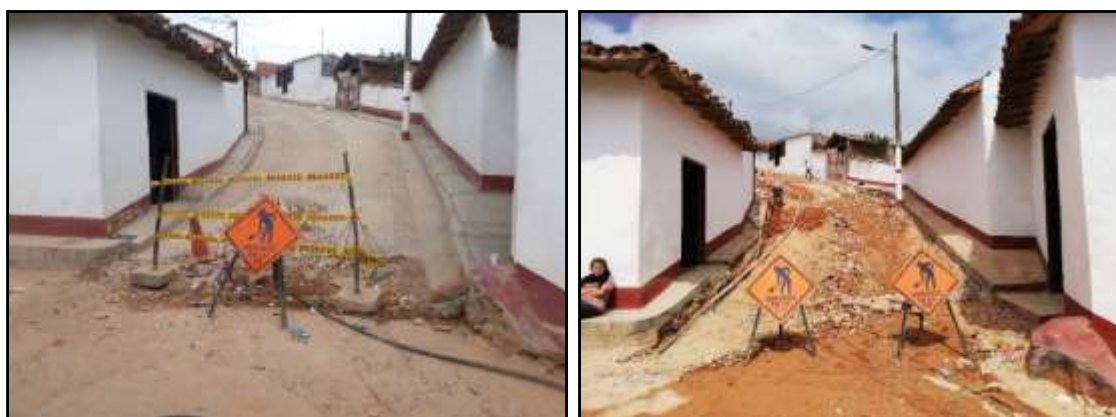
Figura 34. Señalización de obra. Proyecto de estudio No.5 Fuente: Autores del proyecto.
