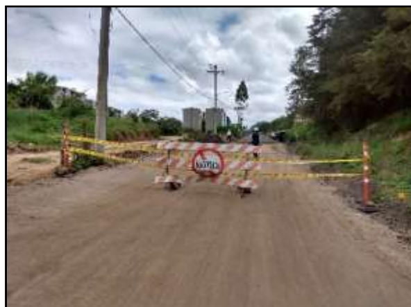
Figura 27. Señalización de obra. Proyecto de estudio No.4. Fuente: Autores del proyecto.
