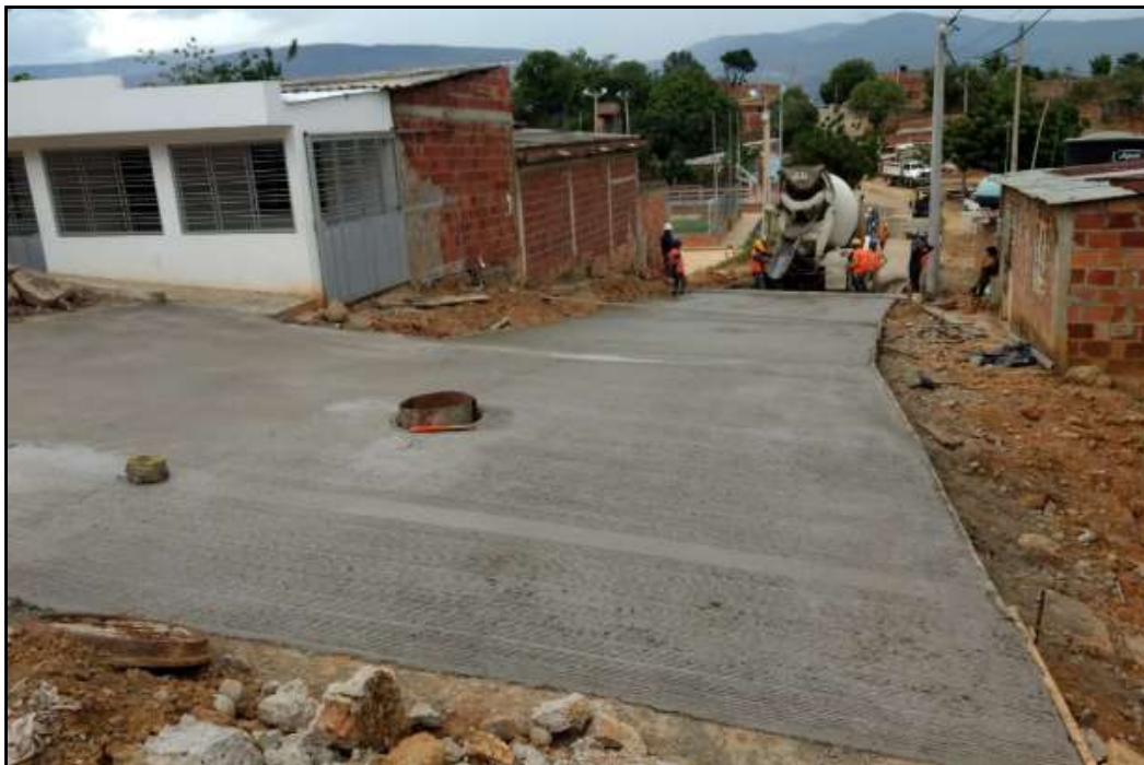
Figura 23. Desarrollo de actividades sin cerramiento señalizado Proyecto de estudio No. 3.
