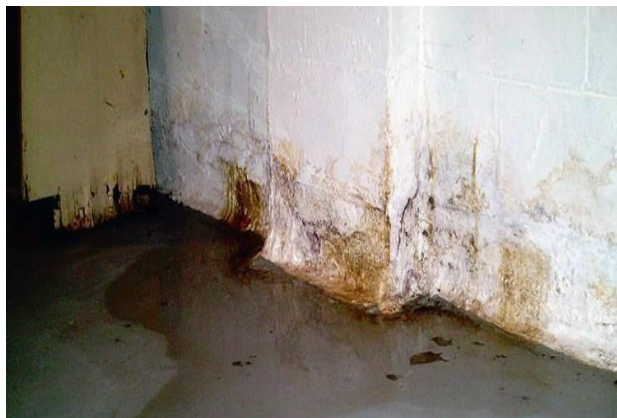
Figura 3. Filtraciones. Palacios A, (2012).
