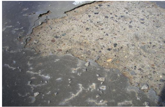
Figura 5. Delaminaciones. Mendoza R, (2014).
