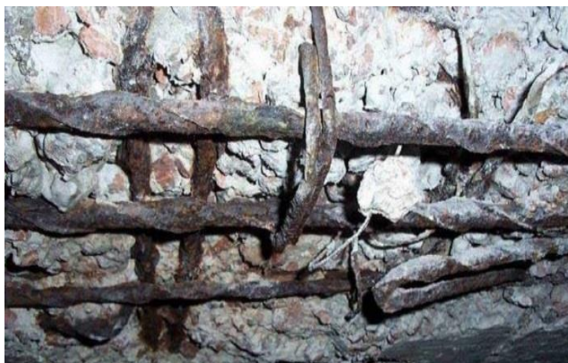
Figura 1. Corrosión del Acero. Paredes J & Prieto J (2013).
