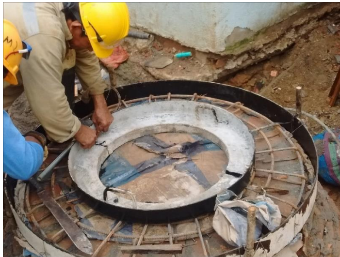
Figura 53. Aplicación de desmoldante en formaleta metálica para corona en concreto reforzado de tapa de pozo de inspección. Autores del proyecto.
