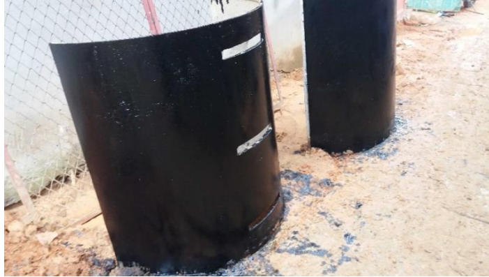
Figura 52. Aplicación de desmoldante en formaleta metálica de pozos de inspección. Autores del proyecto.
