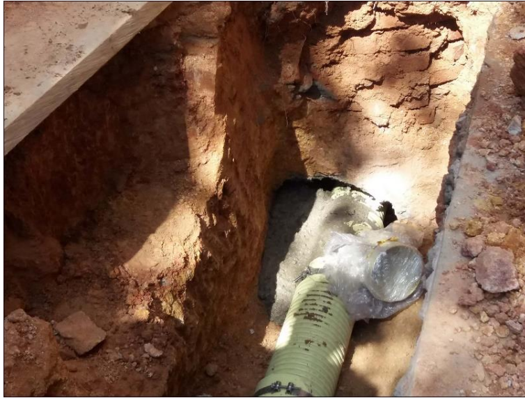
Figura 40. Protección de silla yee para derivación de domiciliaria en instalación de tramo. Autores del proyecto.
