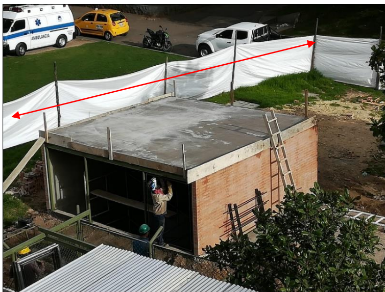
Figura 23. Típico cerramiento en tela de polipropileno blanca. Autores del proyecto.
