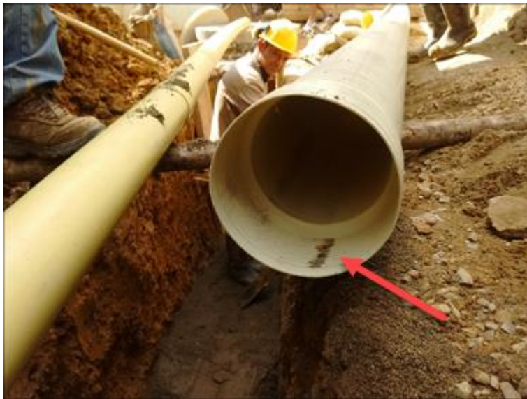
Figura 36. Tubería PVC con partículas de arena en la campana, esto debe retirarse previo a la instalación. Autores del proyecto.
