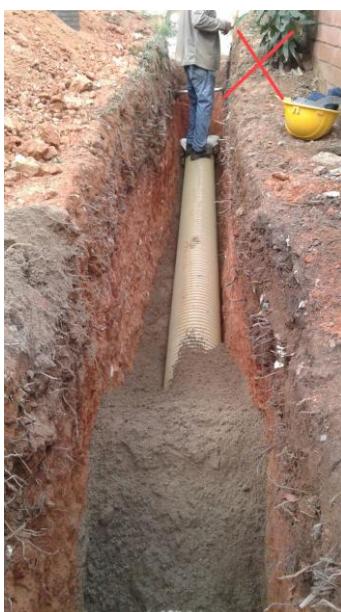
Figura 39. Persona apoyada encima de tubería en PVC. No debe hacerse. Autores del proyecto.
