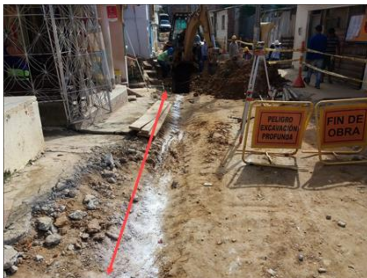
Figura 26. Demarcación con cal para excavación de zanja en un tramo de alcantarillado. Autores del proyecto.
