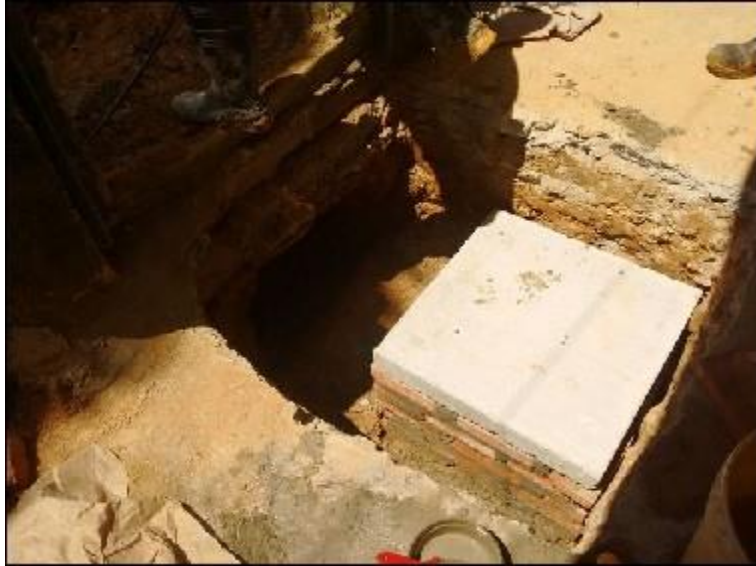
Figura 57. Caja de inspección en mampostería y tapa en concreto reforzado. Autores del proyecto.
