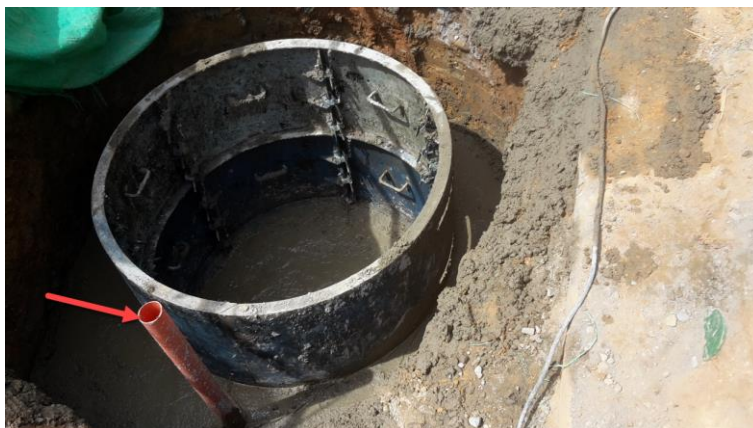
Figura 54. Uso de tubería de ventilación en pozos de inspección. Autores del proyecto.
