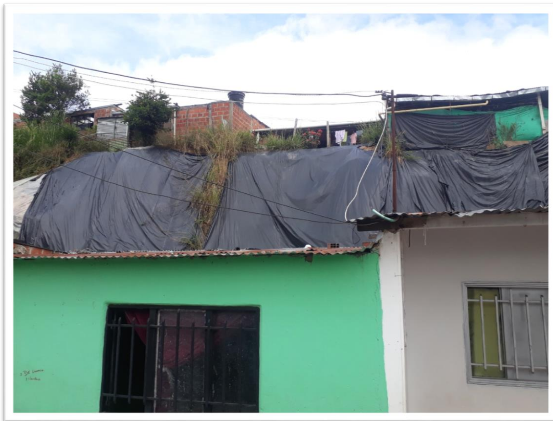
Figura 24 Fotografía talud crítico,barrio Altos del Norte. Autores del proyecto, 2019
