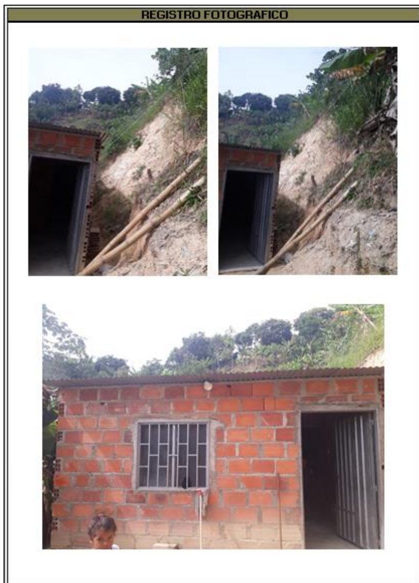
Figura 17 Ficha de caracterización de taludes con fenómenos de remoción o propensos a ellos. (c) (GIGMA, 2019)
