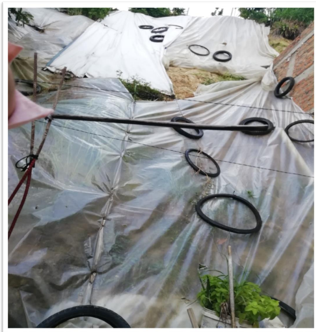
Figura 34 . Fotografía talud critico,barrio La Santa Cruz. Autores del proyecto.2019
