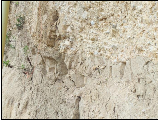
Fotografía 49. Bloques de suelo en el talud.
