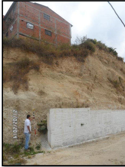
Fotografía 7. Vivienda cercana a la corona del talud.
