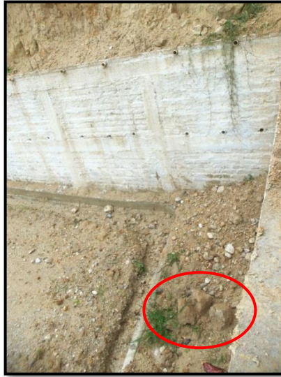
Fotografía 11. Caídos de bloques de suelo.
