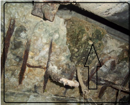
Fotografía 60. Losa 5 recubrimiento inadecuado, acero expuesto, corrosión del mismo y contaminación del concreto.
