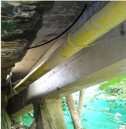
Fotografía 63. Losa anden 2 fisura por sobrecarga de vehículo.
