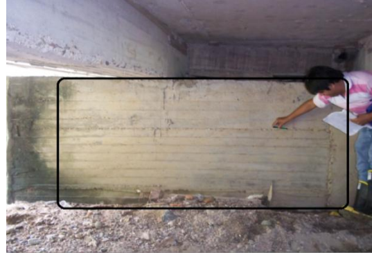
Fotografía 177. Construcción de Juntas Frías inadecuadas.
