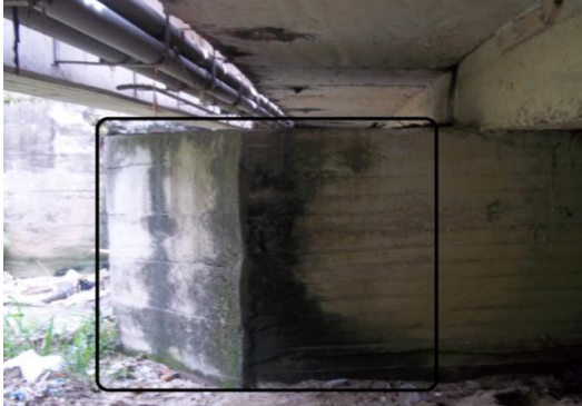
Fotografía 176. Pila, contaminación En el concreto.
