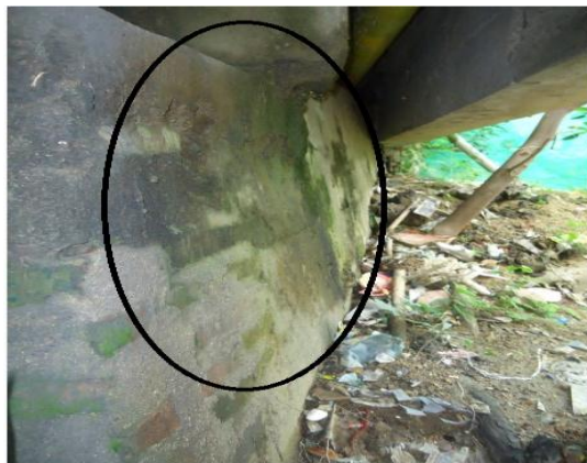
Fotografía 17. Aleta 1 contaminación del concreto.
