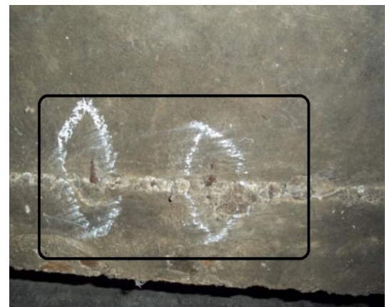
Fotografía 31. Viga 3, acero expuesto.
