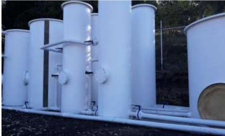
Figura 23. Tanques de almacenamiento
