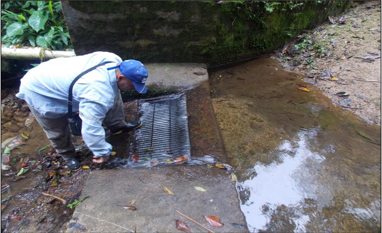
Figura 8. Bocatoma sumergible de captación.
