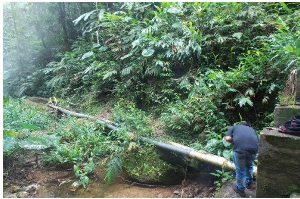
Figura 11. Tubería de aducción bocatoma-desarenador.
