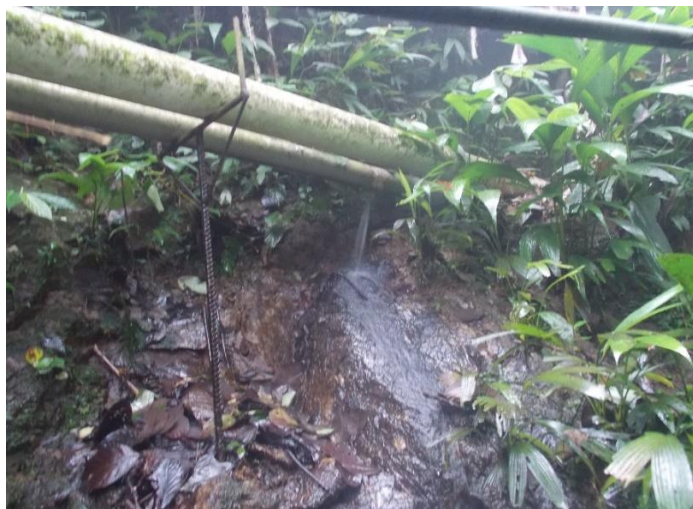
Figura 13. Perforación en la tubería.
