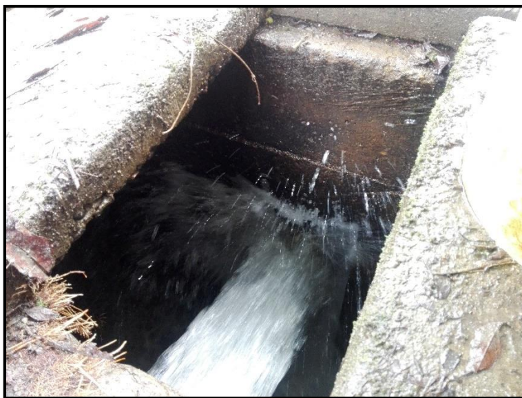
Figura 27. Tapas de concreto reforzado.
