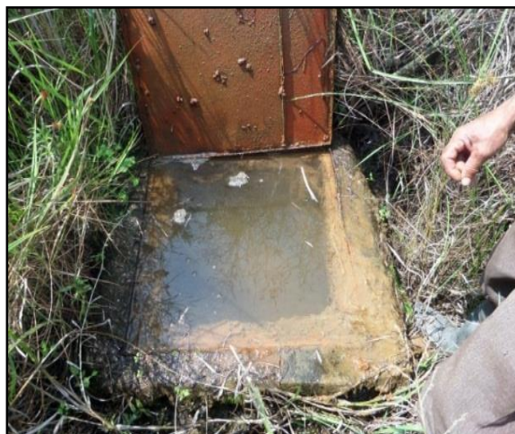
Figura 35. Válvula ventosa en mal estado.
