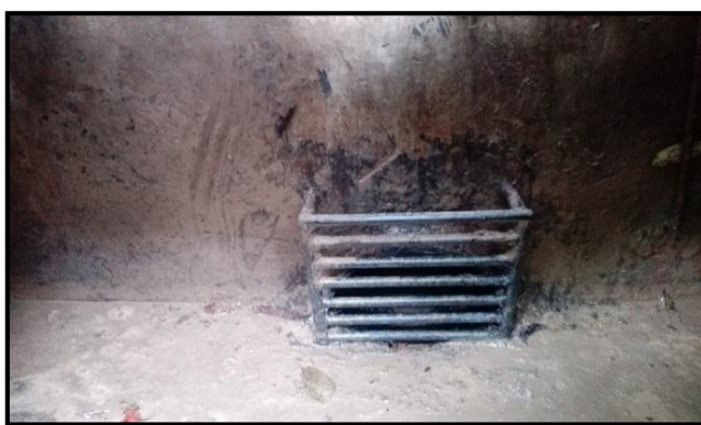
Figura 29. Rejilla de tubería de salida del desarenador.
