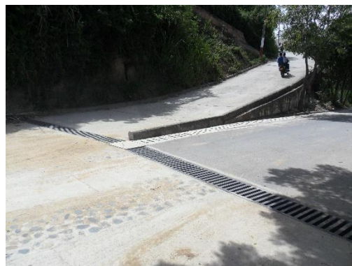
Figura 126. Canal de recolección de aguas lluvia. Fuente: Autor del proyecto
