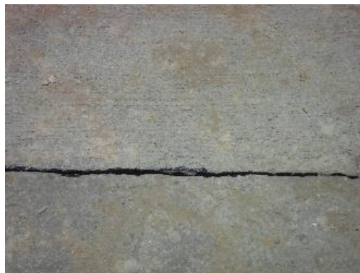
Figura 37. Dilatación sellada con emulsión. Fuente: Autor del proyecto
