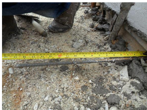
Figura 93. Verificación de longitud (pines) Fuente: Autor del proyecto
