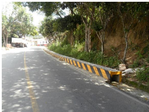
Figura 127. Canal de recolección de aguas Fuente: Autor del proyecto
