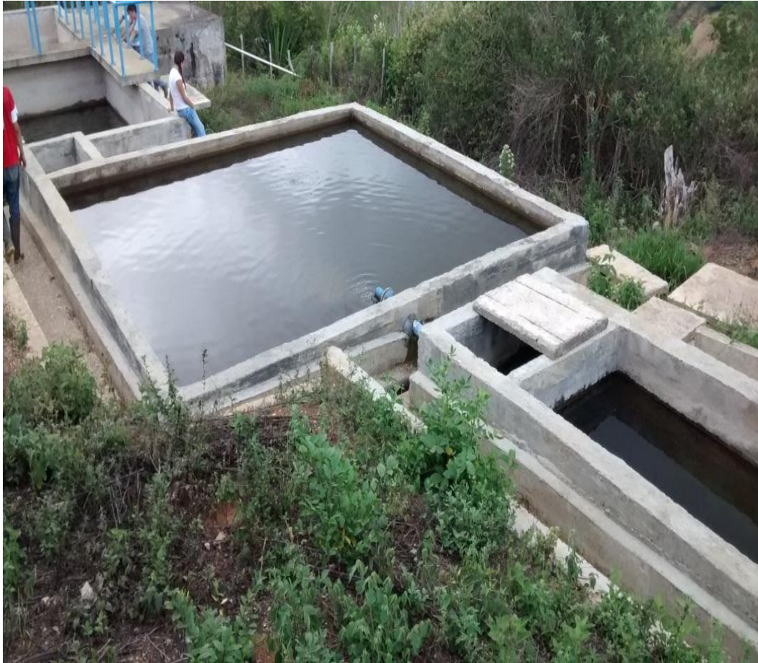
Fotografía 17. Vista general de la PTAP existente.
