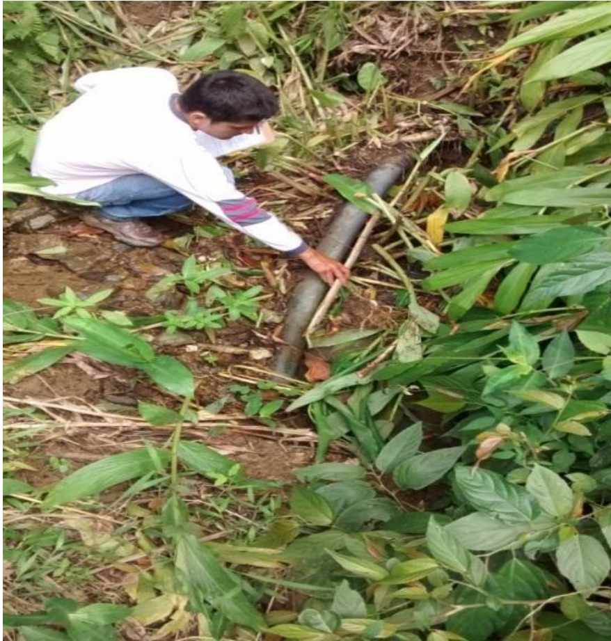
Fotografía 12. Tubería descubierta en un canal natural.
