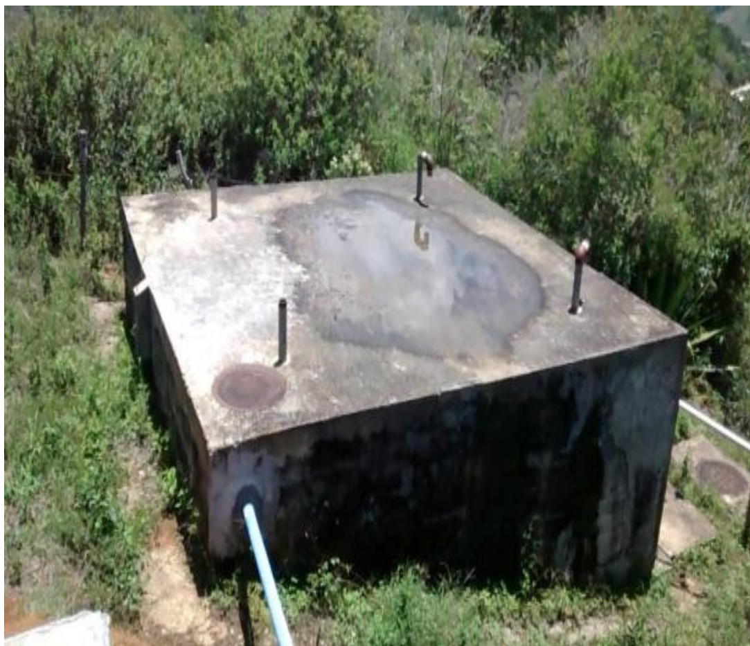
Fotografía 18. Vista general del tanque de almacenamiento
