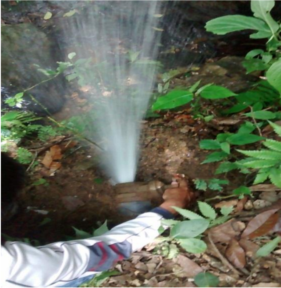
Fotografía 11. Válvula de purga.
