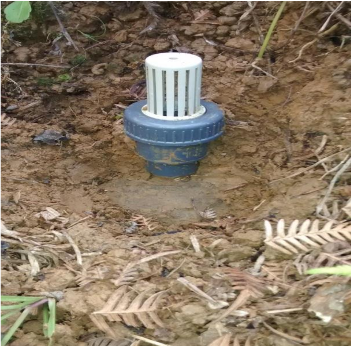
Fotografía 14. Ventosa ubicada en el punto 29. Ver Apéndice 3
