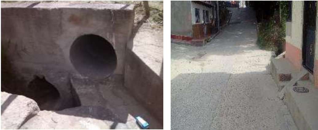
Foto N° 5. Alcantarillas paralelas una encima de la otra.
