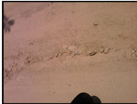
Fotografía 10. Perdida de Agregados Ruta 3 Urbanizacion Alejandria
