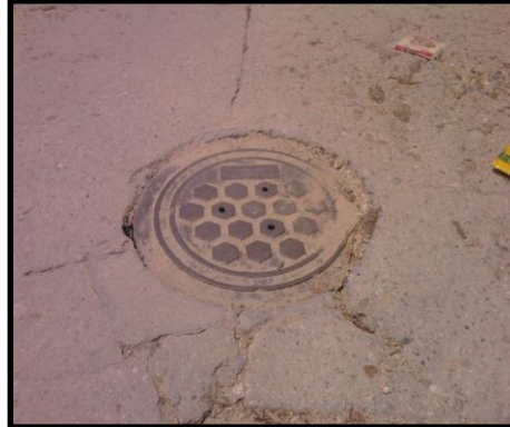
Fotografía 5. Grieta en pozo o sumidero Ruta 1 El Palomar - 9 de Octubre – Barcelona
