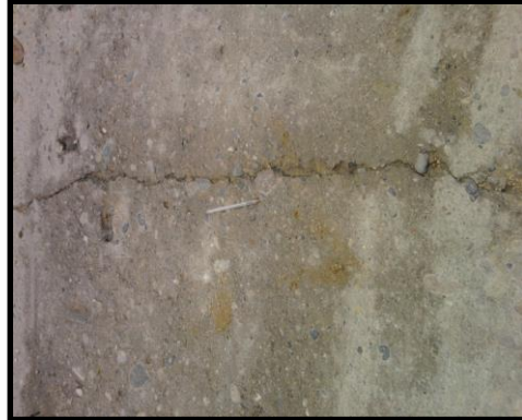
Fotografía 3. Grieta transversal Ruta 8 El Peñon
