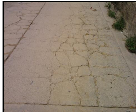
Fotografía 4. Grieta en bloque Ruta 1 El Palomar - 9 de Octubre – Barcelona
