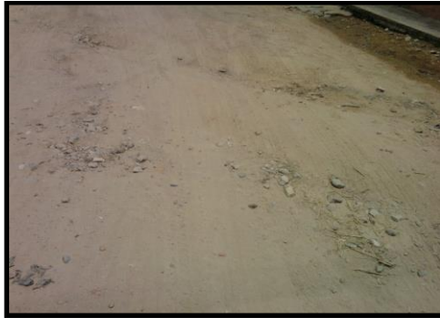
Fotografía 9. Ahuellamiento Ruta 7 Nuevo Horizonte - El Hatillo
