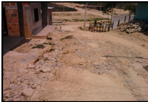
Fotografía 11. Seccion Transversal Inadecuada Ruta 9 Brisas del Polaco
