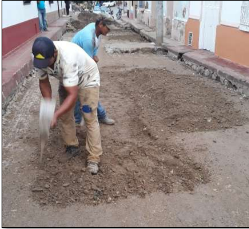
Figura 15. Retiro de material (recebo) mal compactado. Fuente: Autor de la pasantía.
