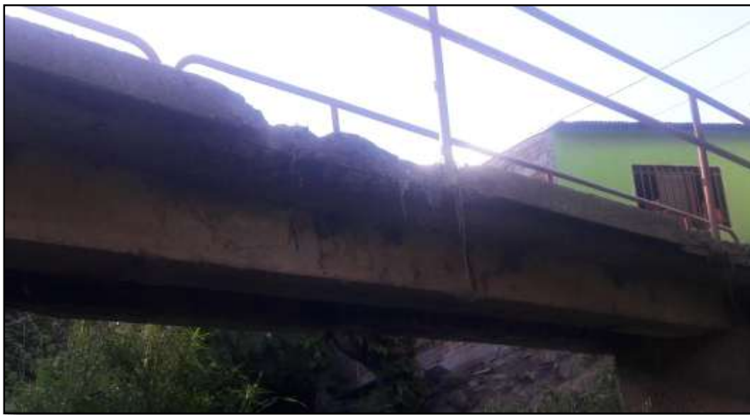
Figura 21. Deterioro de la losa de concreto puente Maciegas. Fuente: Autor de la pasantía.
