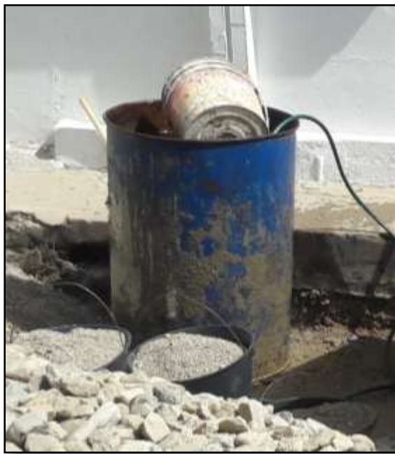
Figura 3. Timbos metálicos de almacenamiento de agua. Fuente: Autor de la pasantía.
