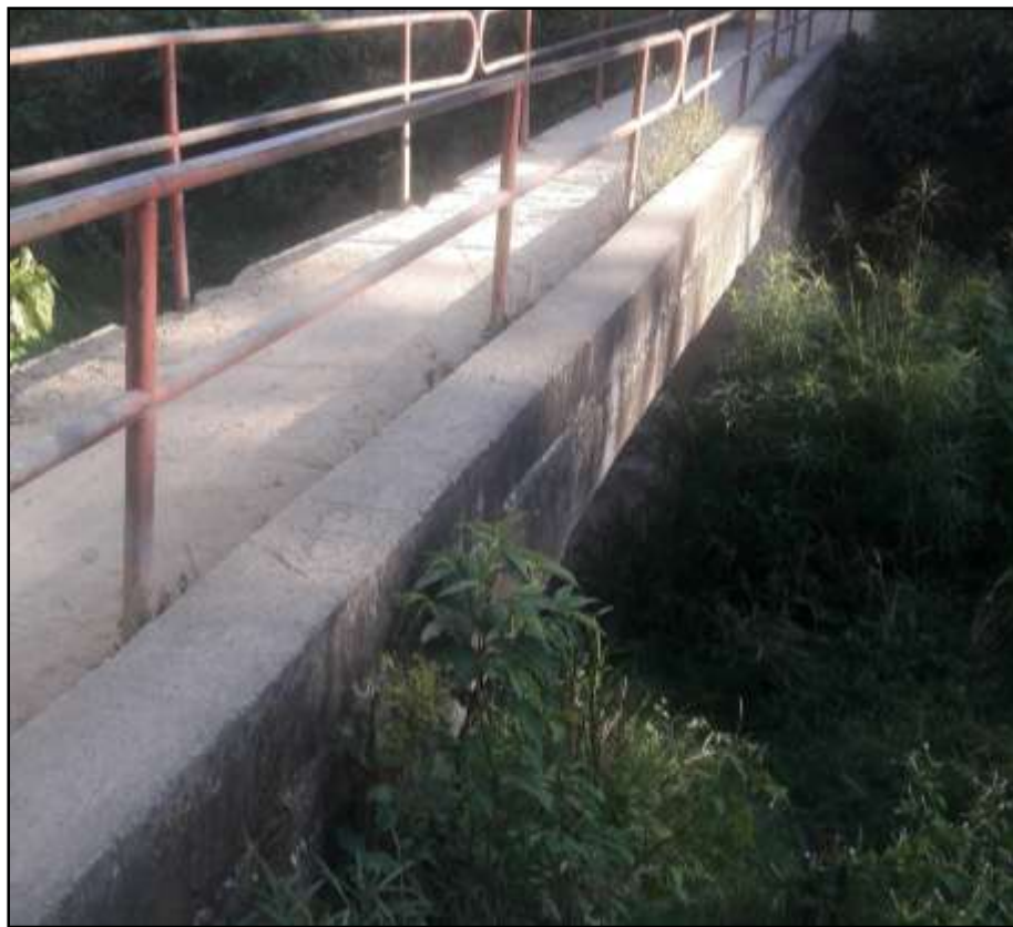
Figura 19. Viga aparente que corresponde al recubrimiento de una tubería de agua potable. Fuente: Autor de la pasantía.
