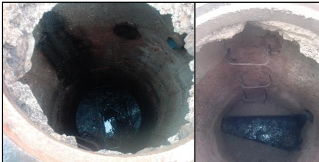
Figura 6. Estado interior de los pozos de inspección alcantarillado viejo.
