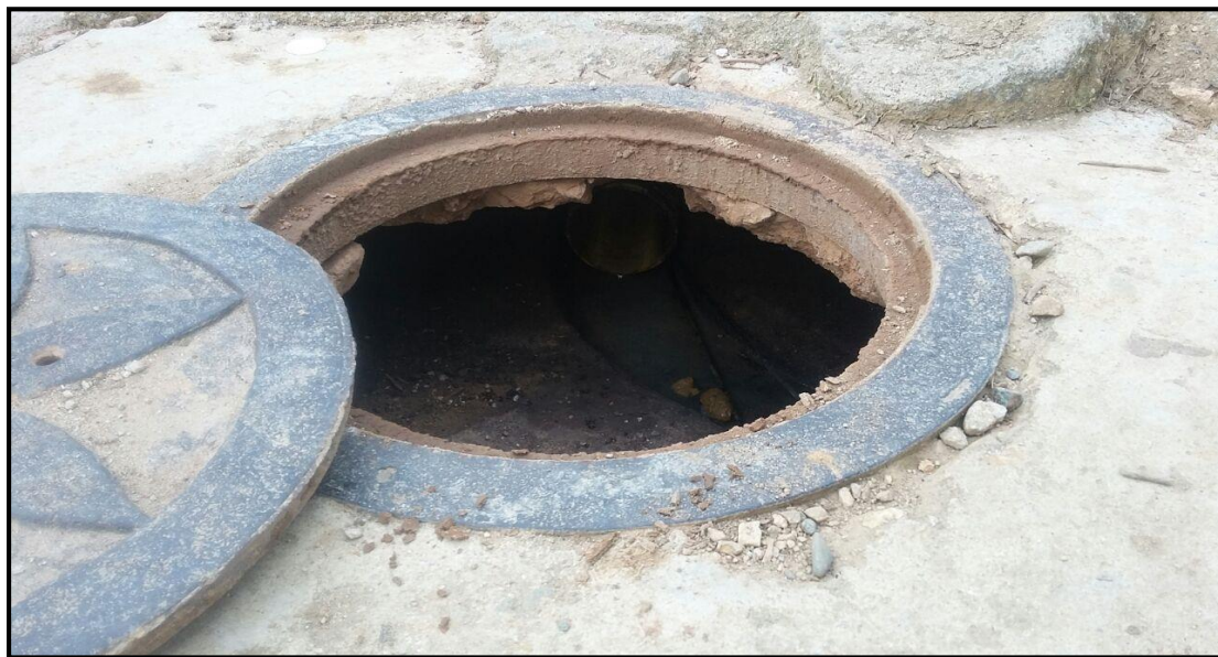
Figura 5. Pozo de inspección en mal estado.
