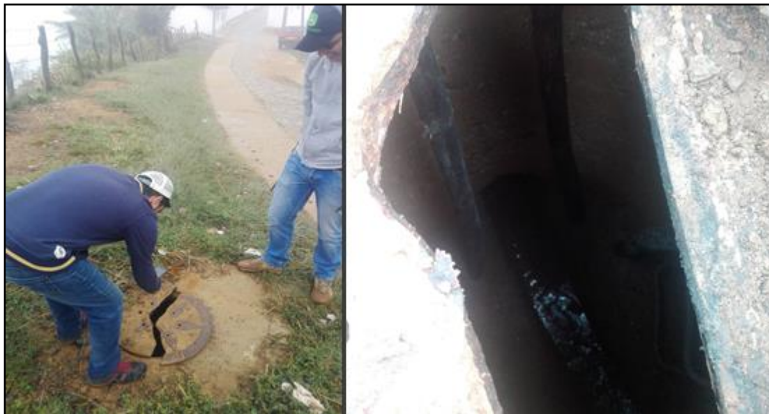
Figura 4. Tapa de pozo de inspección partida y estado interior del pozo.
