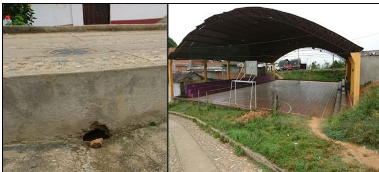
Figura 11. Falencias existentes del alcantarillado nuevo.
