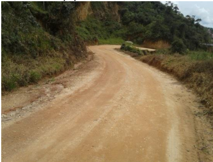
Figura 56. Ausencia señalización, zona de curvas sucesivas la primera a la izquierda. Nota fuente: Autores del proyecto, 2017.
