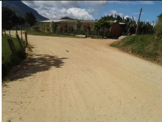
Figura 51. Ausencia señalización, incorporación de tránsito desde la derecha. Nota fuente: Autores del proyecto, 2017.
