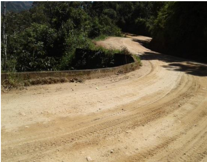
Figura 48. Ausencia señalización, zonda de curvas. Nota fuente: Autores del proyecto, 2017.
