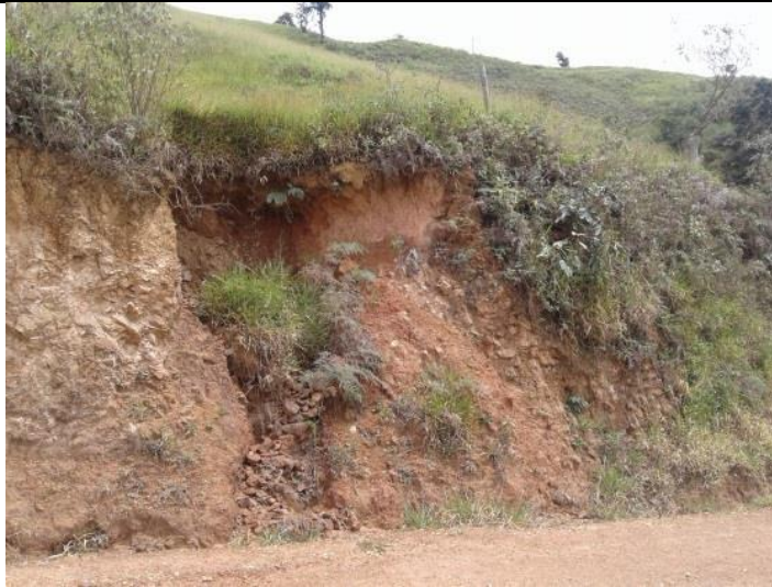
Figura 55. Ausencia señalización, zona de derrumbes. Nota fuente: Autores del proyecto, 2017.
