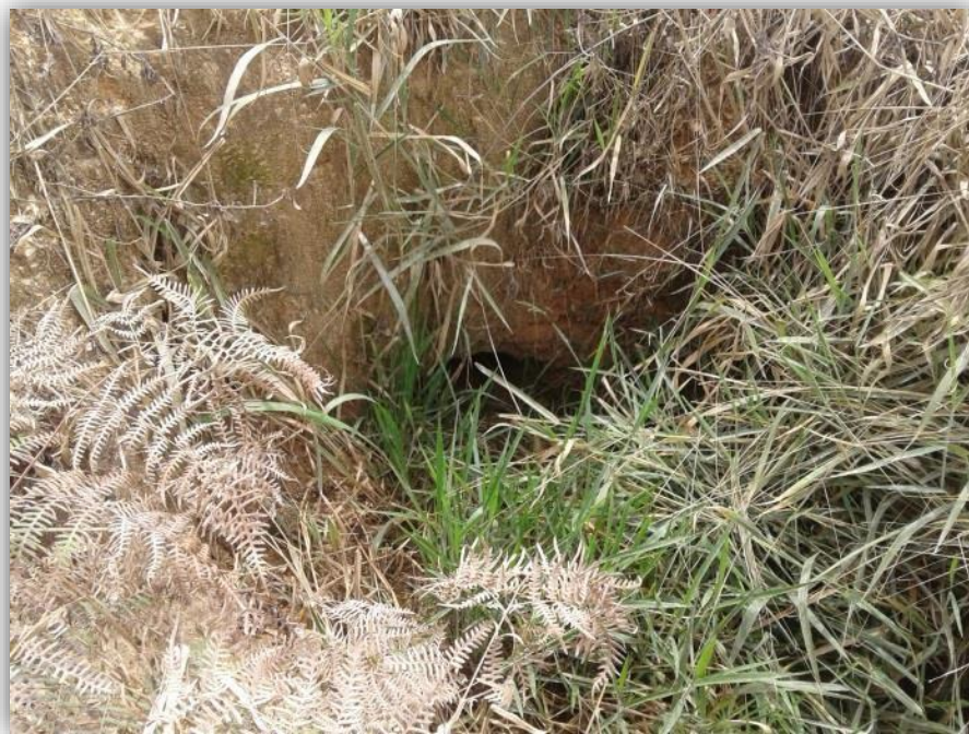
Figura 59. Falta de mantenimiento de Alcantarilla (PR22+150). Nota fuente: Autores del proyecto, 2017.
