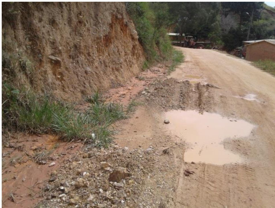
Figura 19. Cuneta con Obstrucción de severidad alta (Tramo: PR22+800-PR22+850) Nota fuente: Autores del proyecto, 2017.
