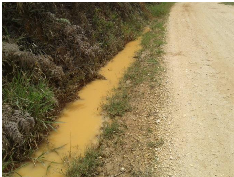
Figura 18. Cuneta con Obstrucción de severidad alta (Tramo: PR22+200-PR22+250) Nota fuente: Autores del proyecto, 2017.
