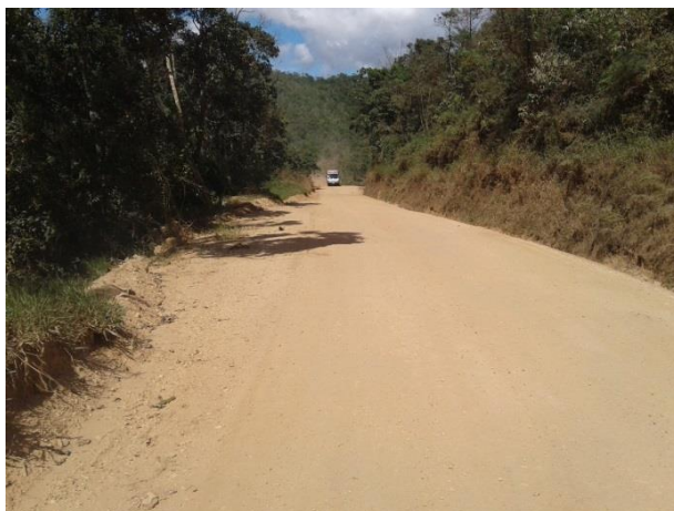
Figura 22. Tramo que requiere sistema de drenaje transversal, Alcantarilla (Tramo: PR20+150-PR20+300). Nota fuente: Autores del proyecto, 2017.
