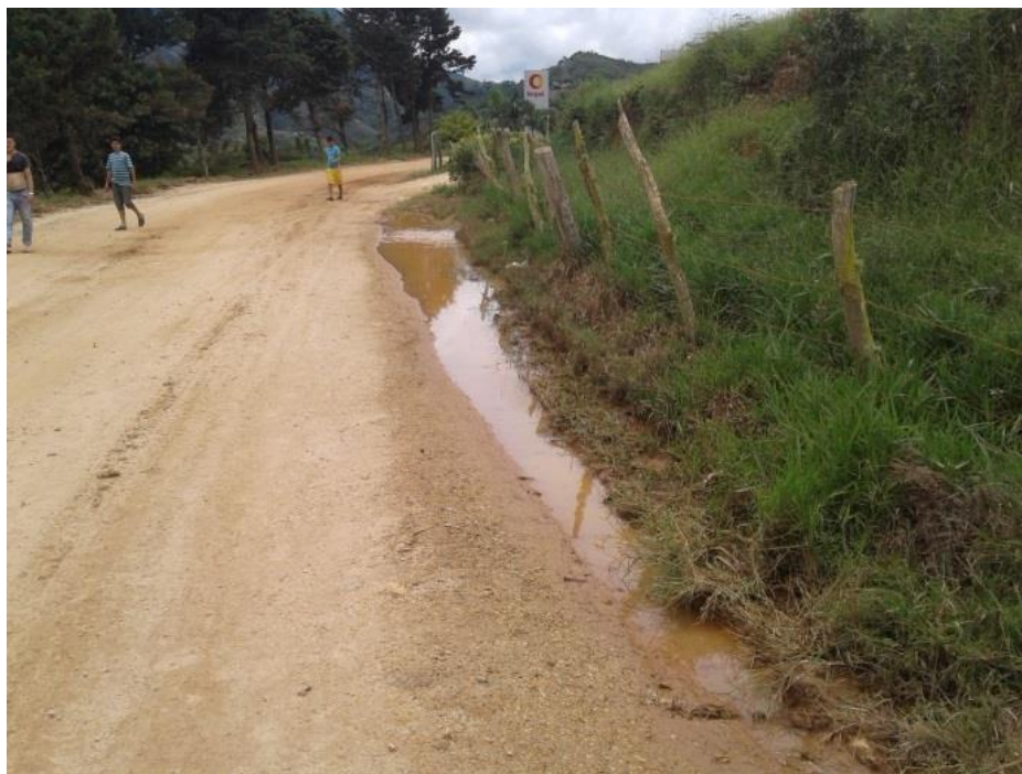
Figura 21. Cuneta con Estancamiento de agua (Tramo: PR21+950-PR22+000). Nota fuente: Autores del proyecto, 2017.
