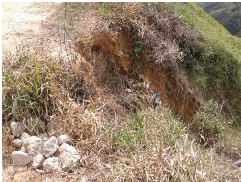
Figura 32. Punto crítico, Con necesidad de construcción de muro de contención (PR22+730). Nota fuente: Autores del proyecto, 2017.
