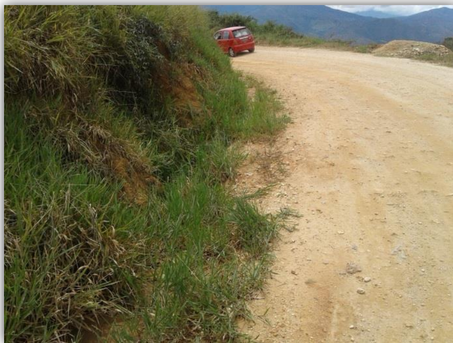
Figura 60. Falta de mantenimiento de cunetas (PR22+450). Nota fuente: Autores del proyecto, 2017.
