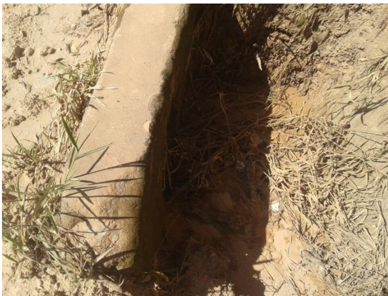
Figura 25. Alcantarilla Obstruida por materiales externos. PR19+420 Nota fuente: Autores del proyecto, 2017
