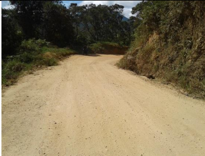
Figura 47. Ausencia señalización, curva pronunciada a la derecha. Nota fuente: Autores, 2017.
