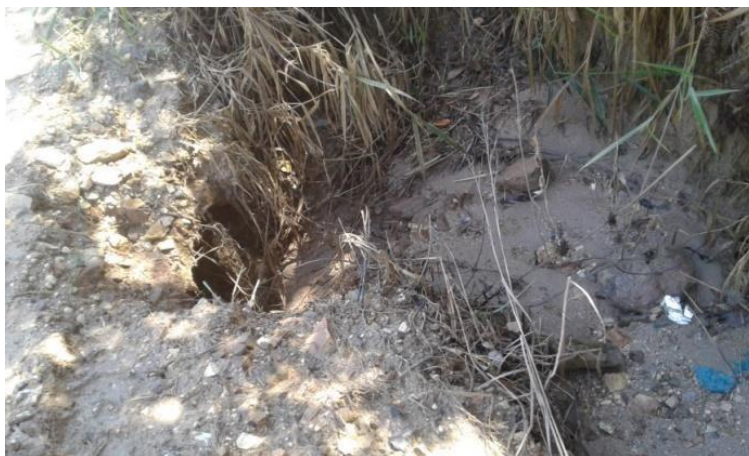
Figura 24. Alcantarilla Obstruida por materiales externos. PR20+390 Nota fuente: Autores del proyecto, 2017.
