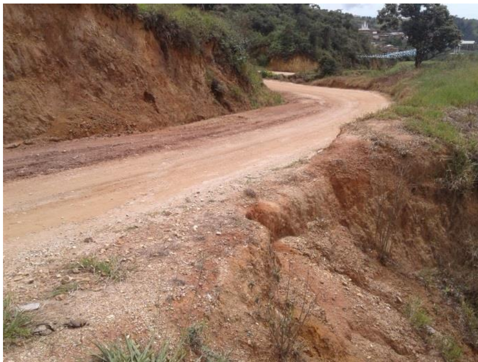
Figura 31. Punto crítico, Con necesidad de construcción de muro de contención PR22+510. Nota fuente: Autores del proyecto, 2017.
