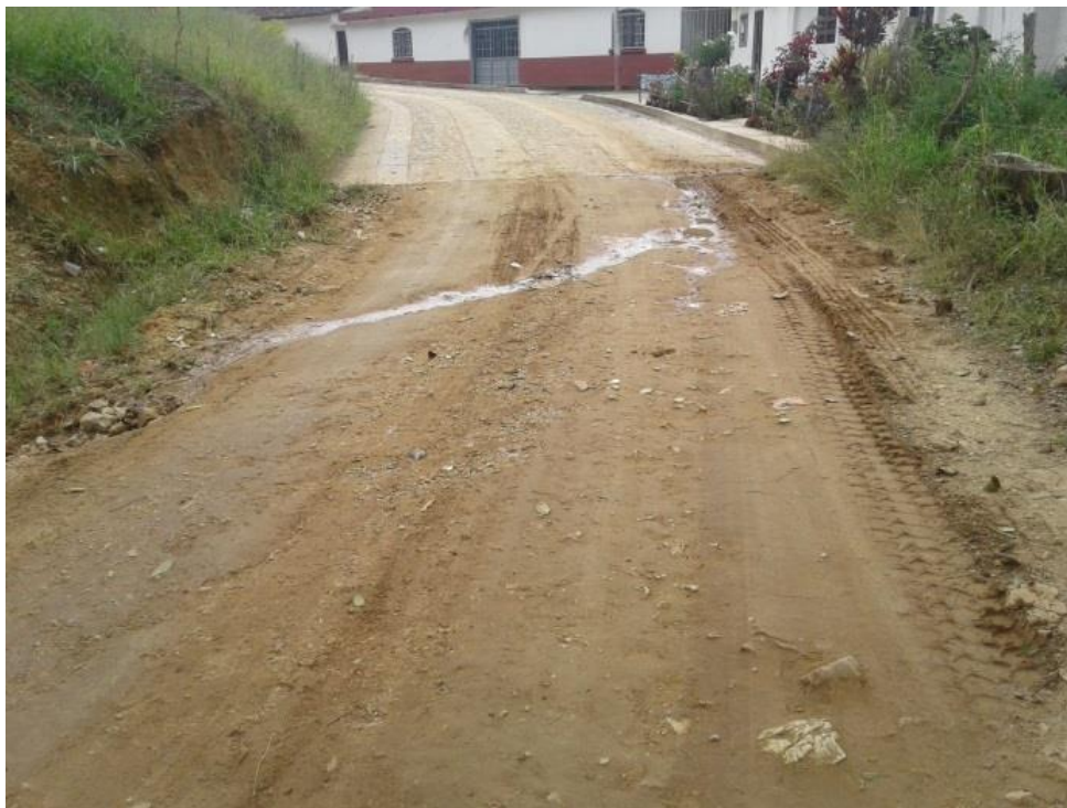
Figura 17. Ausencia Total de cunetas (Tramo: PR22+950-PR23+000) Nota fuente: Autores del proyecto, 2017
