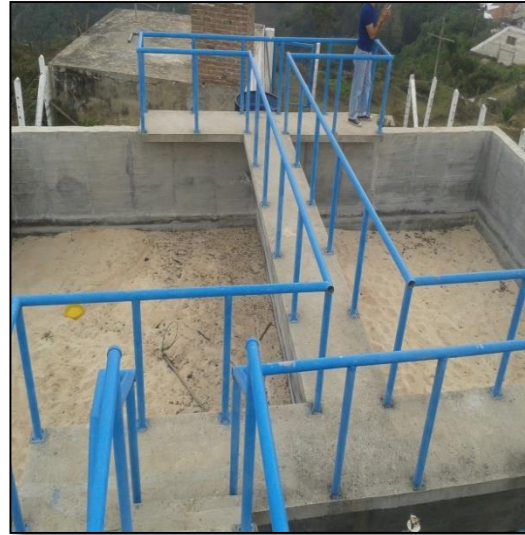
Fuente. Pasante Fotografía N°10. Tanquilla de agua Tratada
