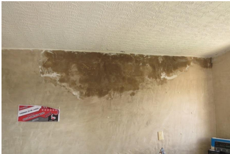
Imagen 9. Humedad en Pared
