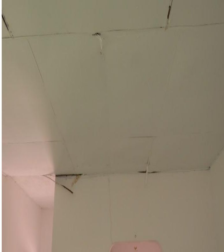
Imagen 12. Daños en Cielo Rasos
