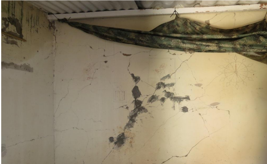
Imagen 8. Fisuras en Bloque.
