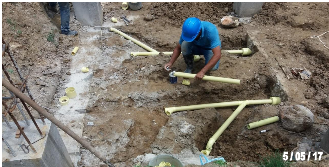
Figura 69. Colocación de tubería PVC para salida sanitaria para el sector de baños.
