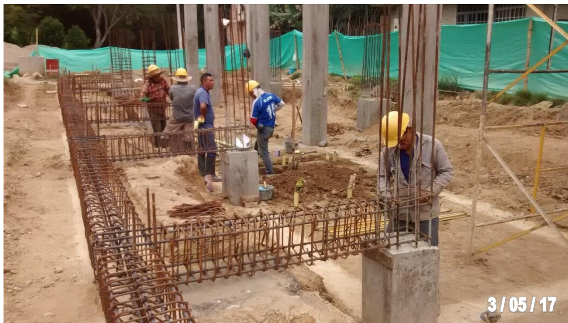
Figura 62. Colocación de estribos 3/8'' a estructuras de refuerzo para vigas F', G' y H'
