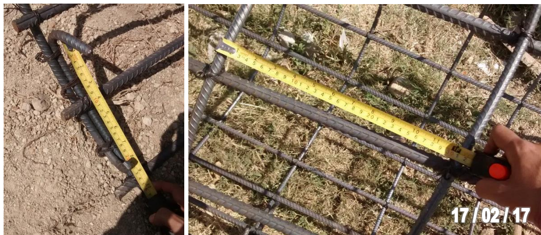
Figura 58. Verificación de separación entre estribos de estructura de refuerzo para pilas.
