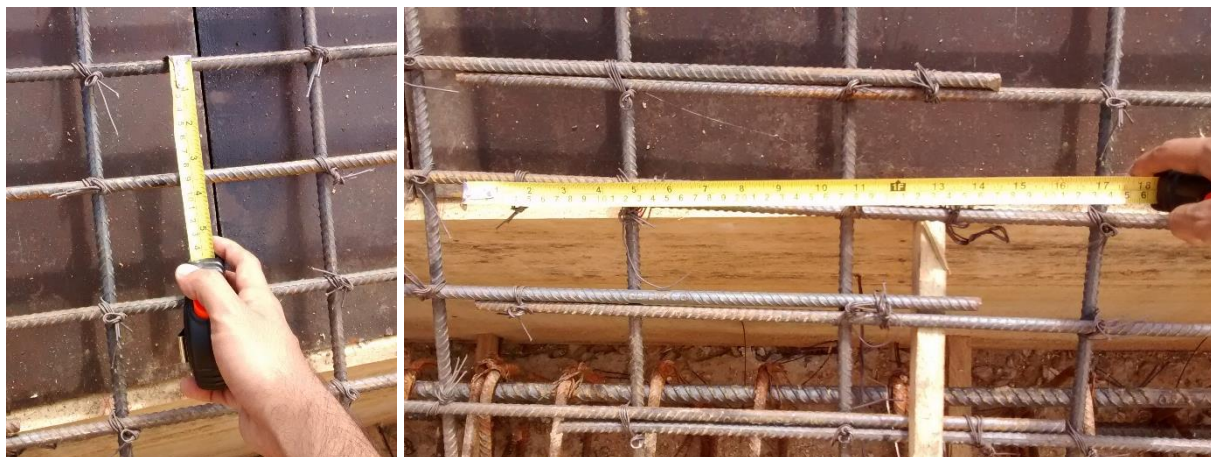
Figura 66. Verificación de separación de varillas y traslapos del refuerzo de losa de gradería.
