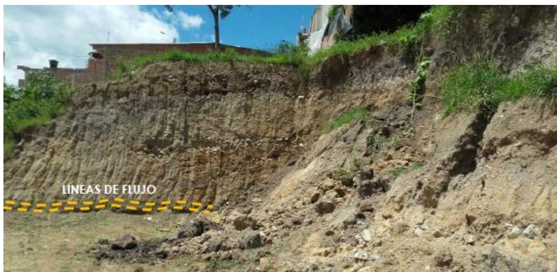
Figura 12. Líneas de flujo capilar que afloran en la base del talud.
