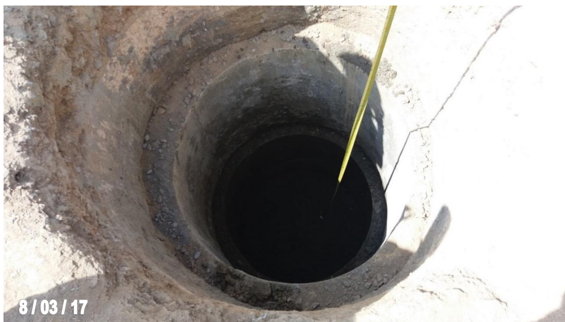
Figura 41. Verificación de distancia de profundidad, previo a la fundición de la pila
