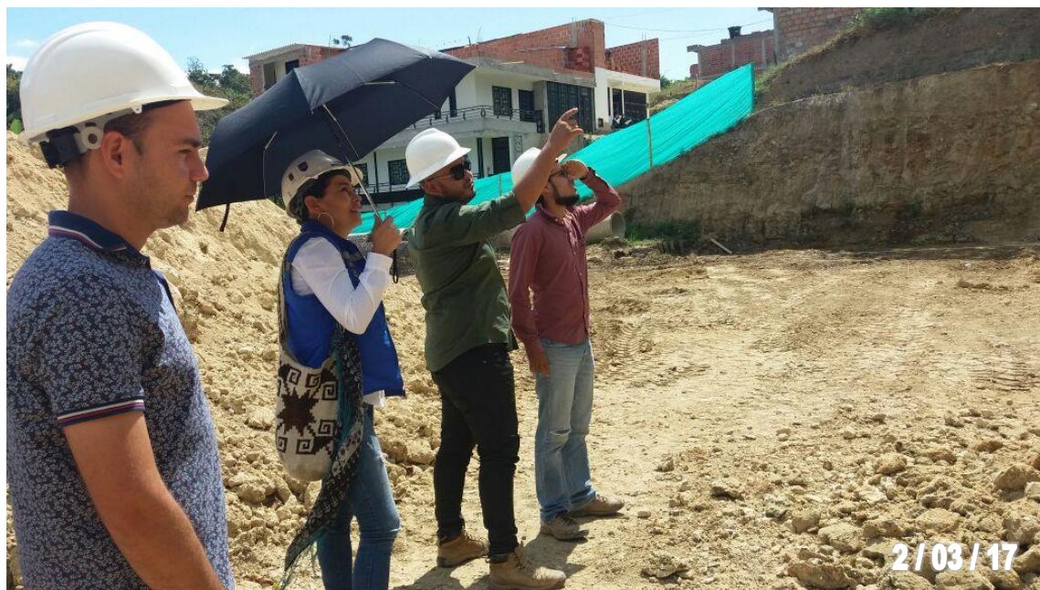
Figura 26. Inspección del derrumbe del talud central del sector occidental.
