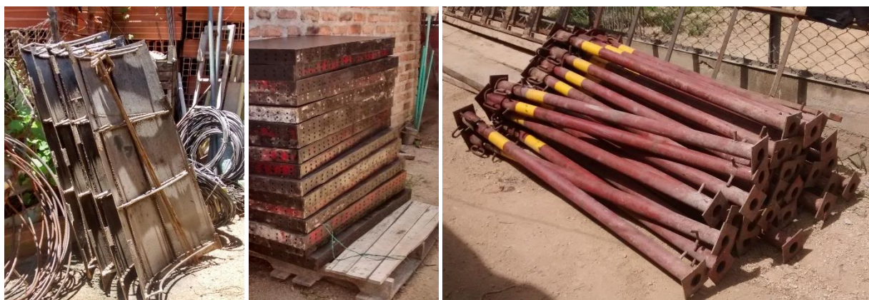
Figura 78. Condiciones de almacenamiento de formaleta metálica, tablero y puntales.
