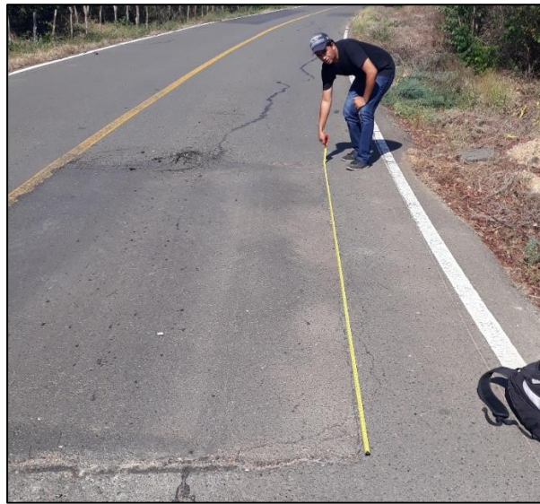
Fotografía. 8 parche de severidad media.
