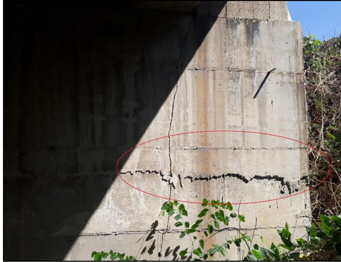
Fotografía. 17. Construcción inadecuada de juntas frías en un estribo
