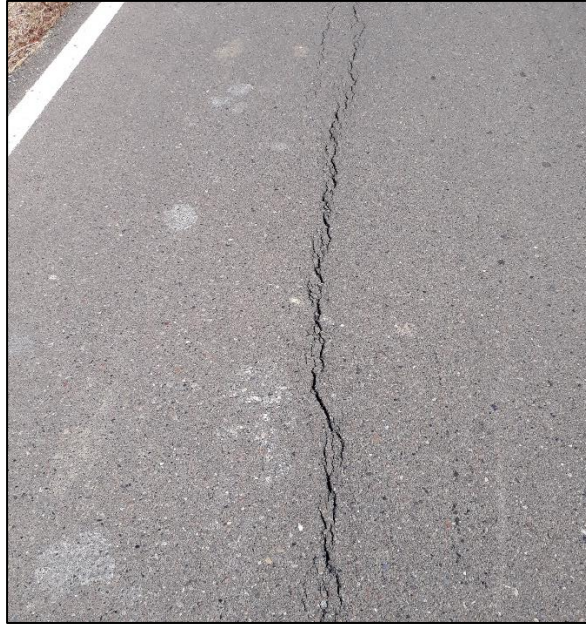
Fotografía. 7 Fisura longitudinal de severidad alta
