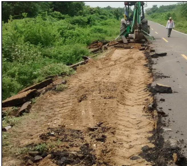
Fotografía. 32. Demolición de carpeta en uno de los puntos que presenta fisura media luna Fuente: autor del proyecto
