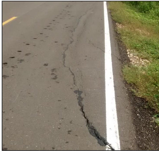
Fotografía 4. Fisura media luna de severidad alta
