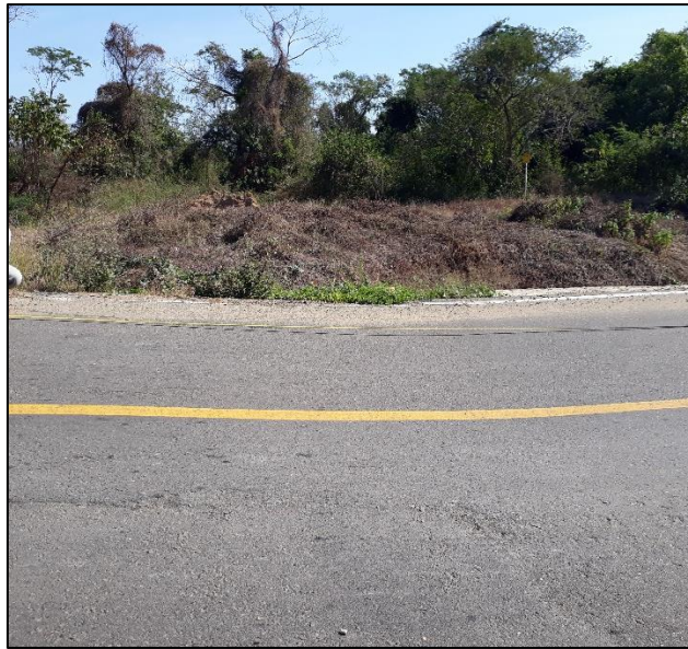
Fotografía 5. Hundimiento de severidad media
