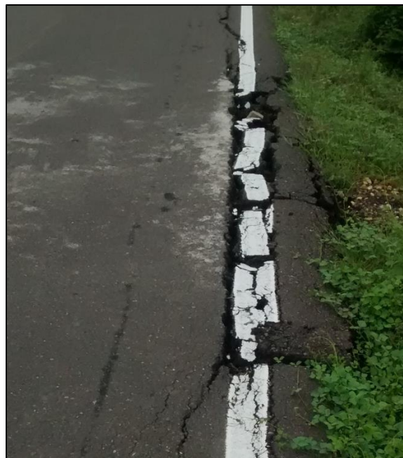
Fotografía.3 Fisura de borde de severidad alta
