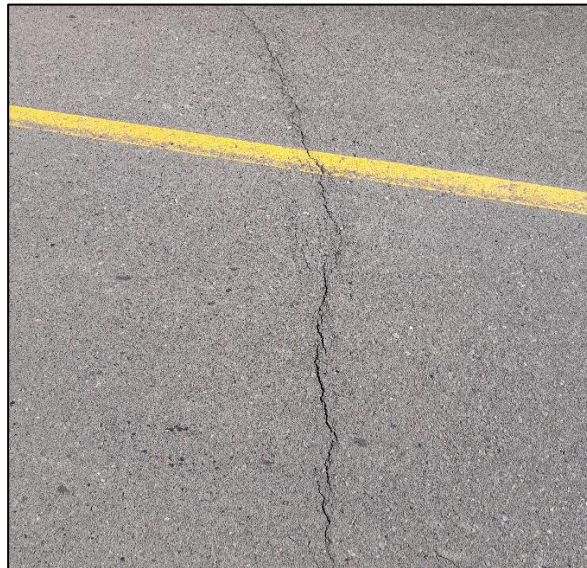
Fotografía. 6 Fisura transversal de severidad media
