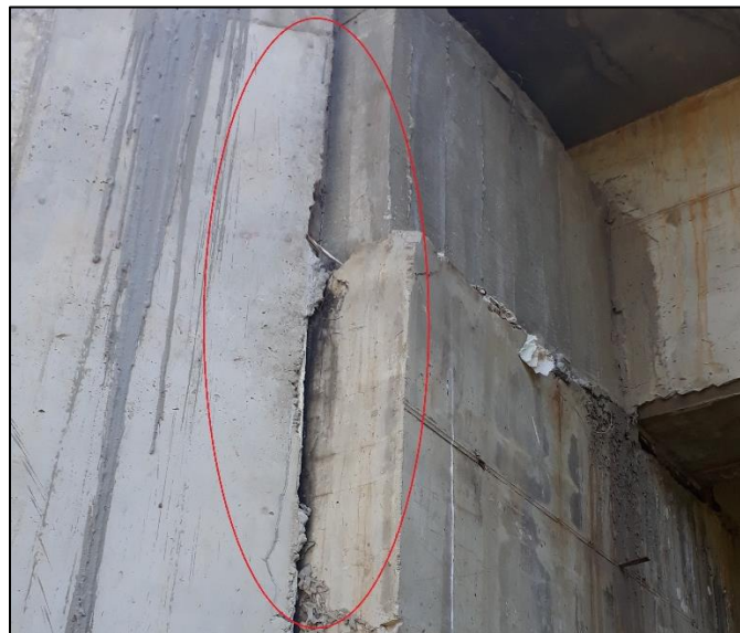
Fotografía. 18. Grieta vertical entre la unión del estribo con la aleta
