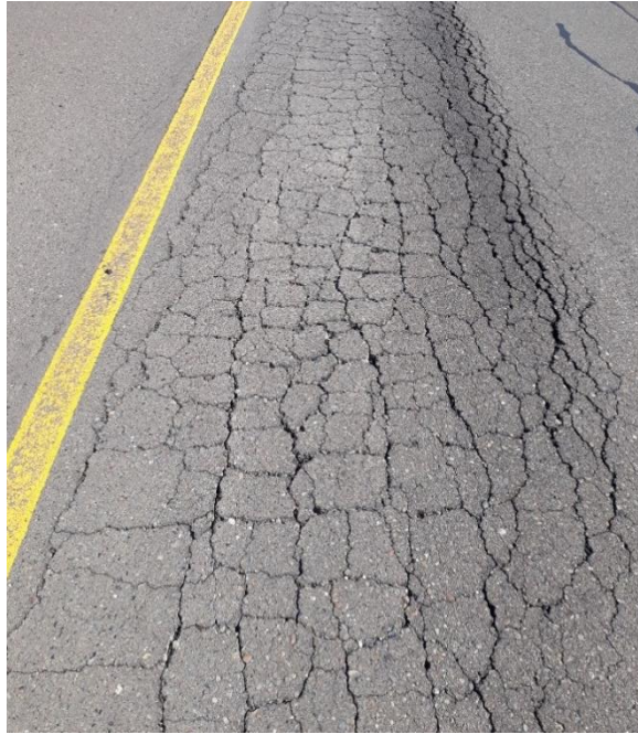
Fotografía. 2. piel de cocodrilo de severidad alta
