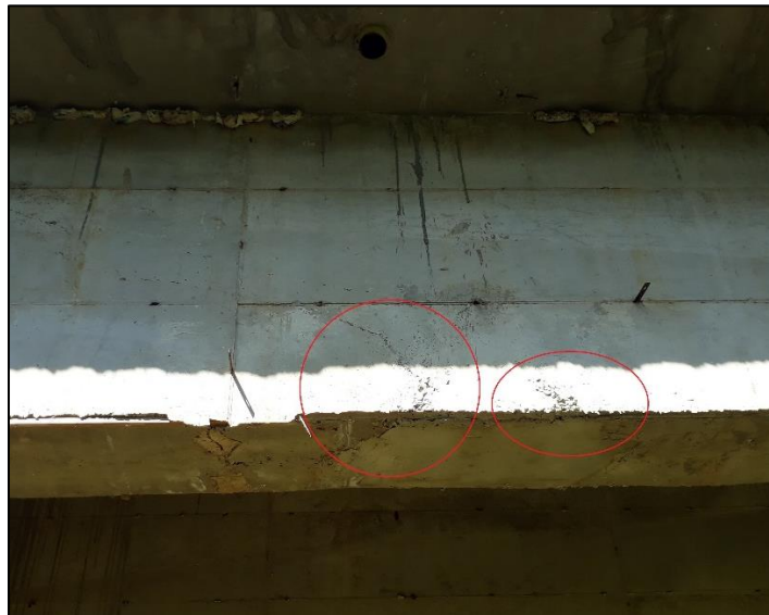
Fotografía. 16. Evidencia de hormigueros en una de las vigas del puente
