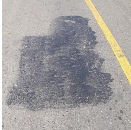
Fotografía. 9 Exudación de severidad alta
