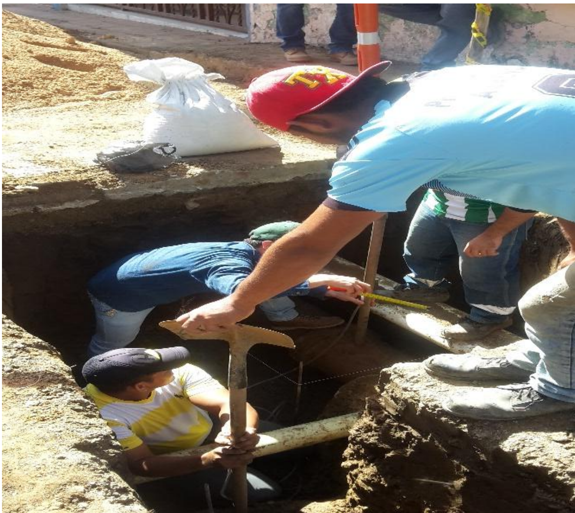
Figura 32. Trabajadores sin los equipos de seguridad.
