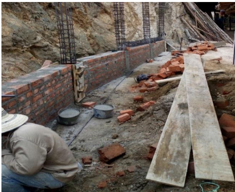
Imagen 19. Muro en ladrillo doble de obra, Calle EL Faro. Fuente: pasante del proyecto.
