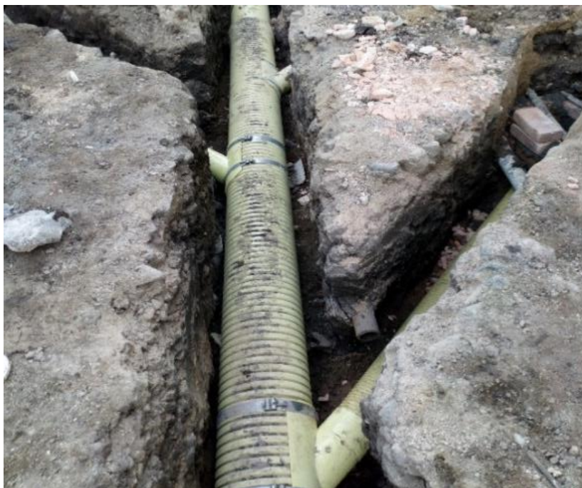
Imagen 13. Suministro e instalación silla yee 12" x 4", Calle Bolívar. Fuente: pasante del proyecto.
