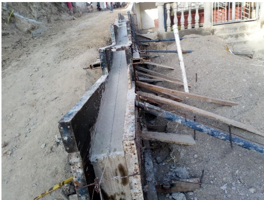
Imagen 17. Concreto de 3000 psi para muro de contención., Calle Jerusalén. Fuente: pasante del proyecto.
