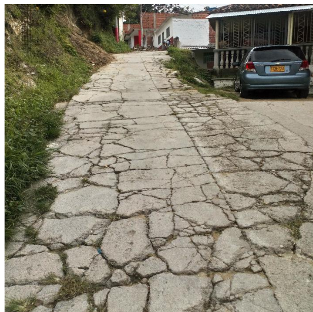
Descripción: estado inicial del pavimento. Ubicación: Calle Jerusalén Fecha: 11/10/2017
