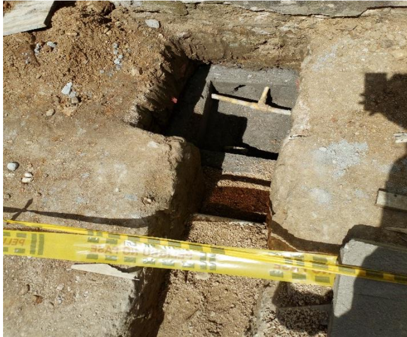
Imagen 8. Caja de inspección de 60x60x60cm, en concreto de f'c=3.000\text{psi} , Calle Bolívar. Fuente: pasante del proyecto.
