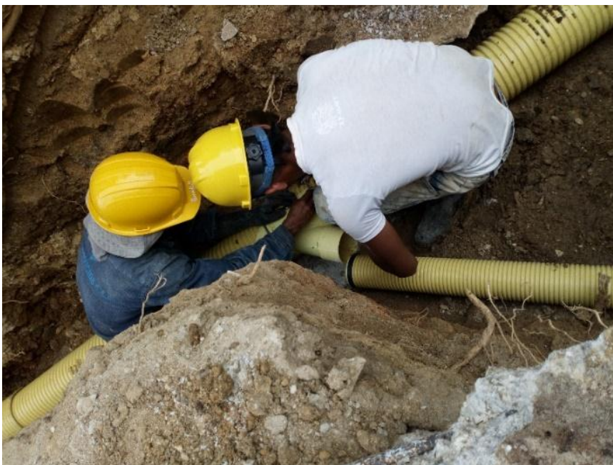
Imagen 12. Suministro e instalación de tubo 4" alcantarillado PVC, Calle Jerusalén. Fuente: pasante del proyecto.
