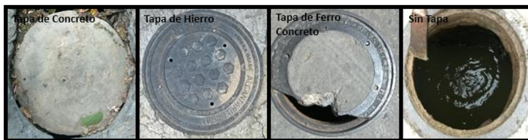
Figura 7. Tipos de Tapas de los Pozos de Inspección.
