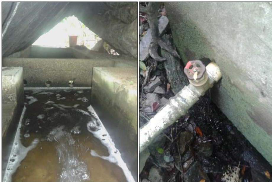
Figura 5 Desarenador encontrado en concreto reforzado, quebrada la Onda
