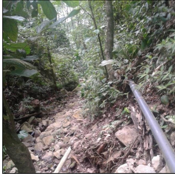
Figura 4 Tubería de aducción 4" PVC
