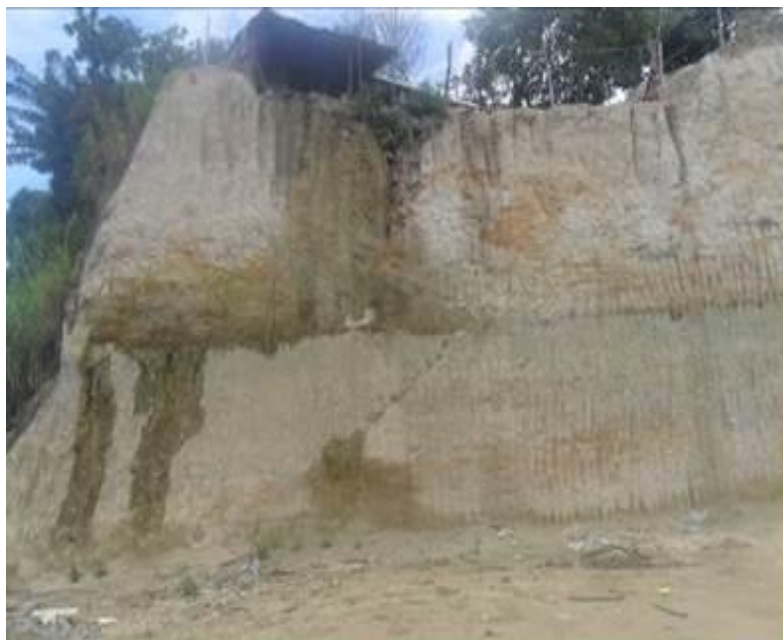
Foto 39. Presencia de agua en el talud barrio Belén
