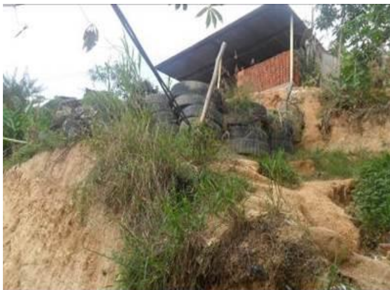
Foto 12. Descarga de aguas al talud barrio Colinas de la Provincia
