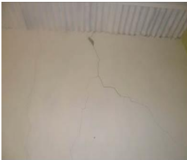
Foto 32. Grietas en la vivienda barrio Santa Cruz
