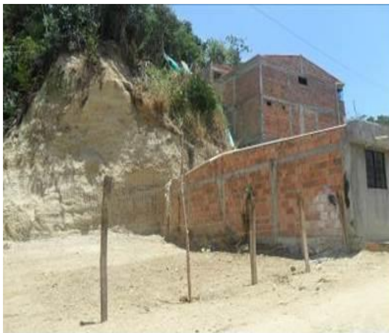
Foto 36. Ladera propensa a deslizamientos barrio Santa Lucia
