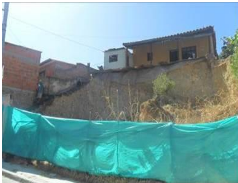
Foto 13. Deslizamiento barrio Camino Real
