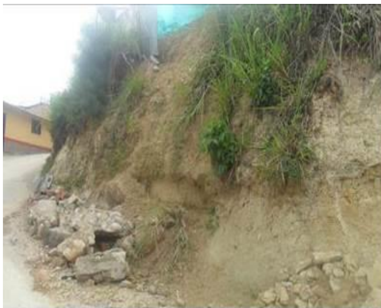
Foto 22. Deslizamiento barrio 9 de Octubre
