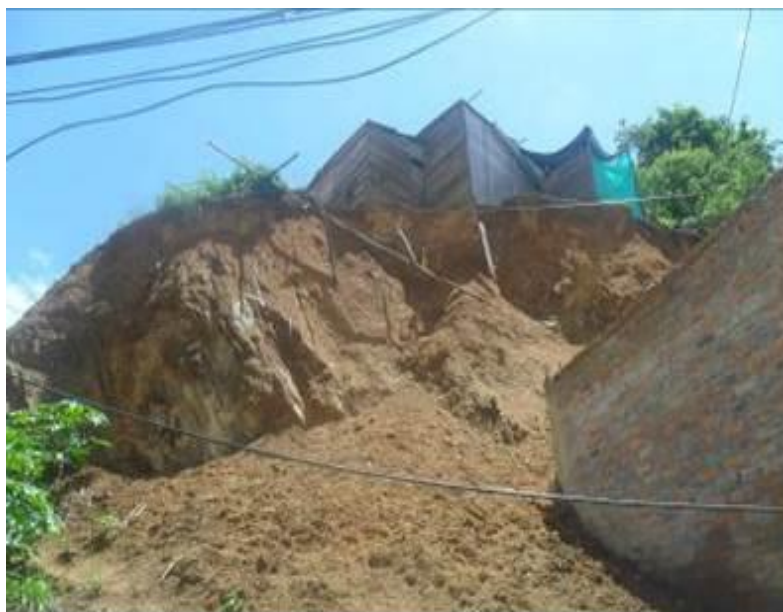
Foto 42. Vivienda en la corona del talud barrio Colinas de la Provincia
