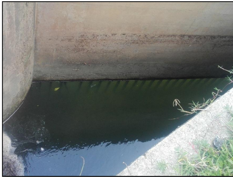
Figura 12. Rejilla de captación lateral bocatoma Rio Frio. Fuente: Autores del proyecto.
