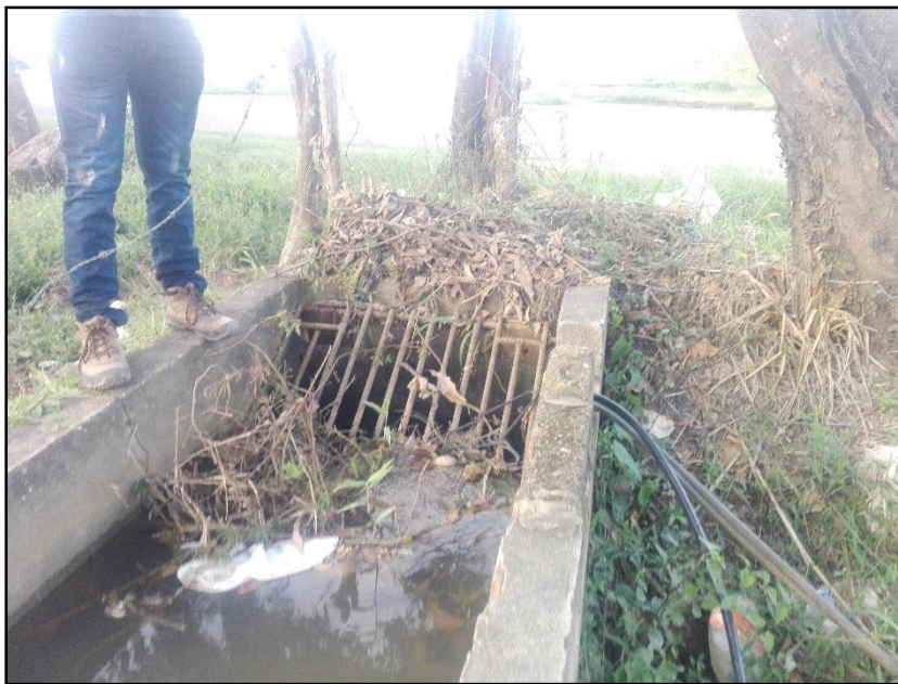
Figura 36. Deterioro de canales secundarios y tomas por manguera no legales. Fuente: Autores del proyecto.
