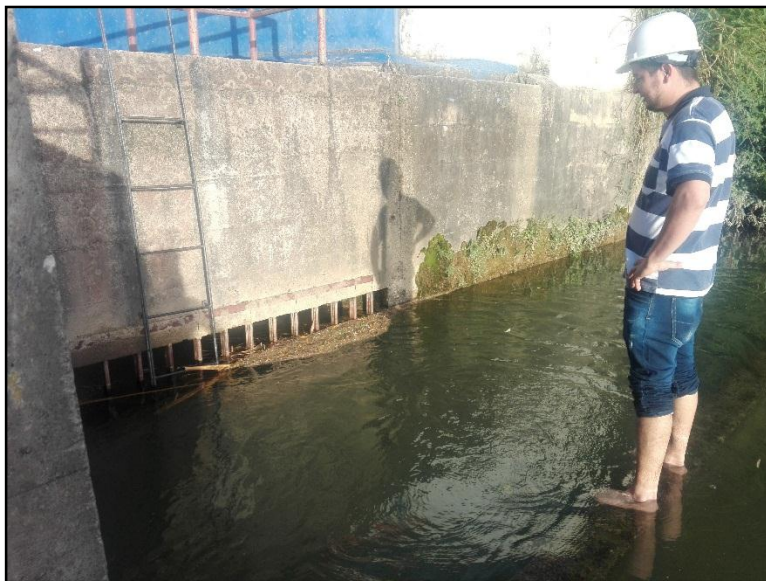
Figura 19. Rejilla de captación lateral bocatoma Rio Oroque. Fuente: Autores del proyecto.
