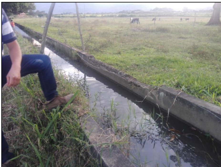
Figura 35. Canal secundario con deterioro en su infraestructura. Fuente: Autores del proyecto.
