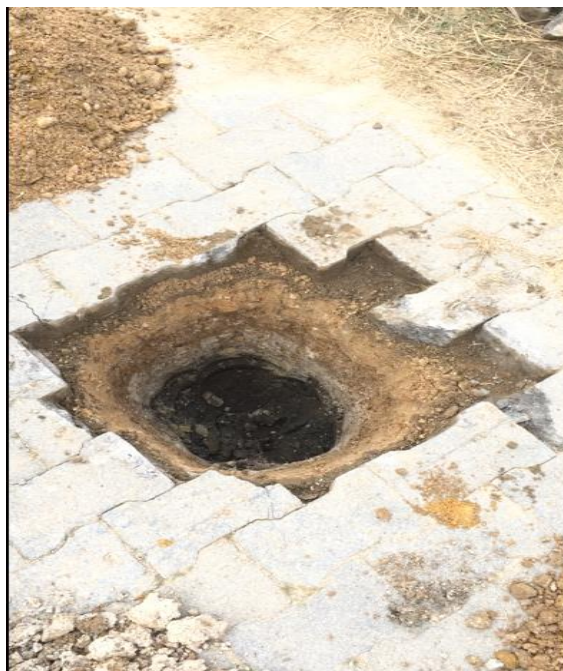
Fotografía 20. Excavación para extracción de los diversos tipos de materiales des suelo existente encontrados en sitio.
