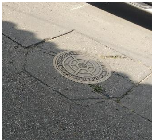
Figura 23. Grieta en Pozo de Inspección. Sector Clínica la Torcoroma. Fuente: autor del proyecto.
