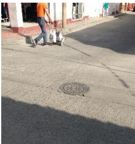
Figura 18. Estado de la vía. Sector del Carretero. Fuente: autor del proyecto
