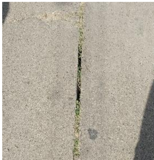
Figura 10. Daño por bombeo. Sector del Tamaco. Fuente: autor del proyecto
