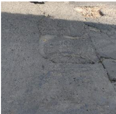
Figura 19. Bache y grietas. Sector del Carretero. Fuente: autor del proyecto
