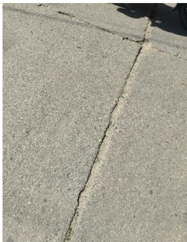
Figura 27. Separación de Juntas. Sector de San Agustín - La Luz. Fuente: autor del proyecto.
