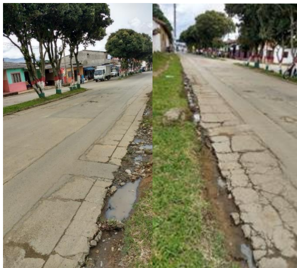
Figura 4. Grietas Transversales y longitudinales. Municipio de Abrego. Fuente: Autor del proyecto
