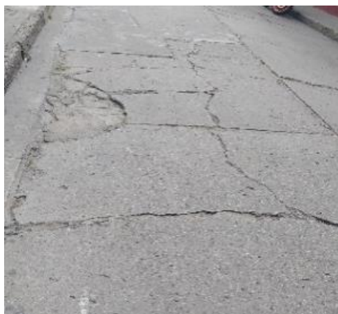
Figura 20. Grietas. Sector del Tamaco. Fuente: autor del proyecto.
