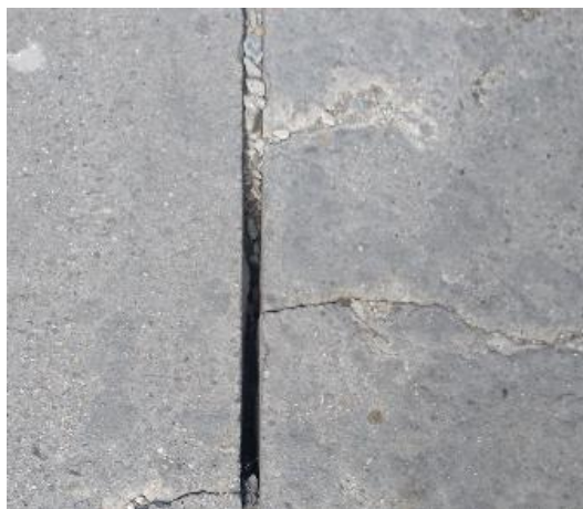
Figura 9. Daño por bombeo. Sector de San Agustín. Fuente: autor del proyecto
