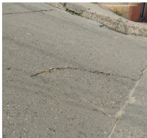
Figura 24. Grieta de esquina. Sector Clínica la Torcoroma. Fuente: autor del proyecto.
