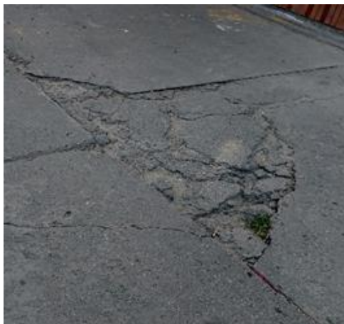
Figura 5. Grieta de esquina. Sector de Clínica la Torcoroma. Fuente: autor del proyecto
