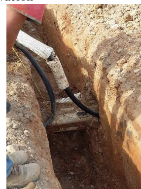
Daño en fibra óptica
