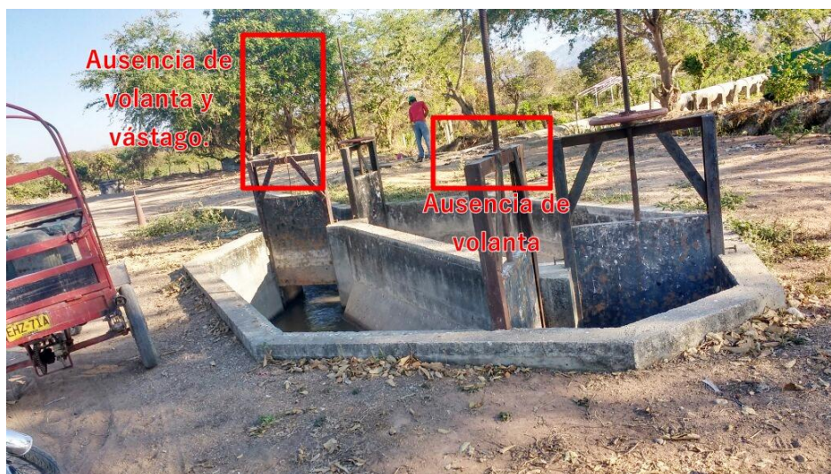
Figura 11. Desarenador Fuente: (Pasante, 2017)
