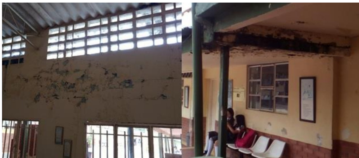
Figura 28. Deterioro de muros y placa en la institución Agustina Ferro
