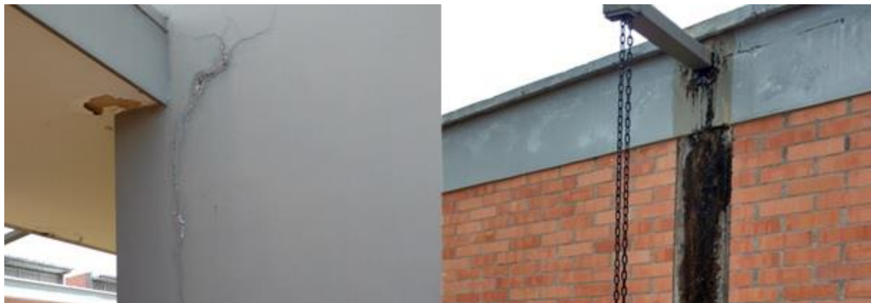
Figura 20. Filtración de agua en muros por mal funcionamiento de los desagües
