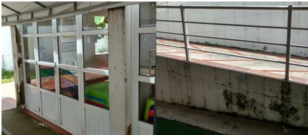
Figura 22. Fachada deteriorada por humedad
