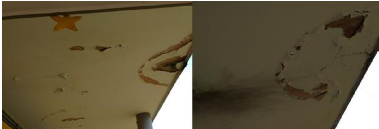
Figura 17. Placa afectada por filtración de aguas lluvia
