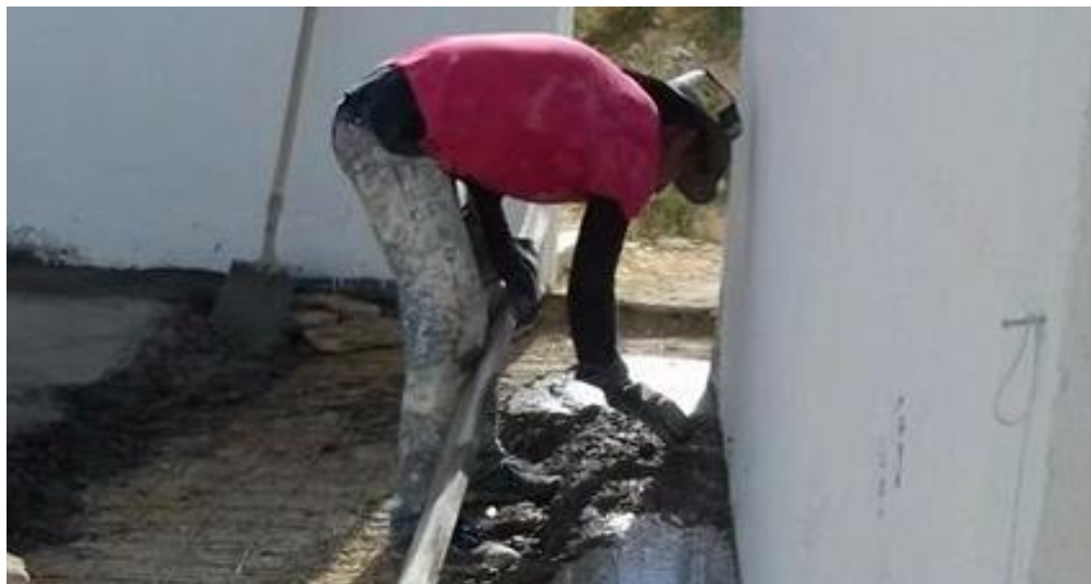
Figura 78. Indumentaria incompleta en el vaciado de pisos
