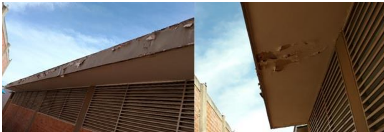
Figura 19. Viga canal en mal estado
