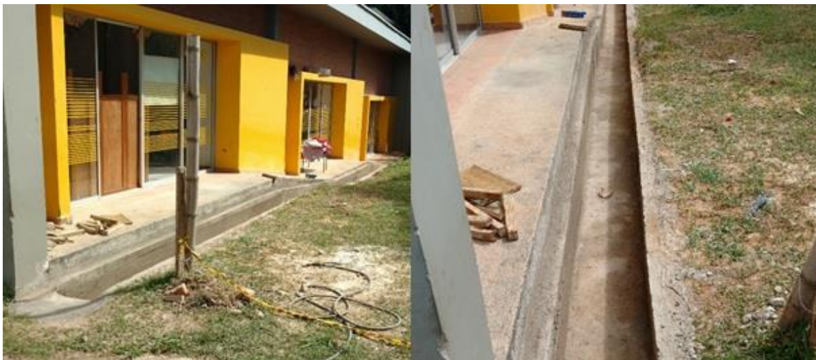
Figura 76. Ausencia de cerramiento en canal de desagüe (S. Nuevo Amanecer)
