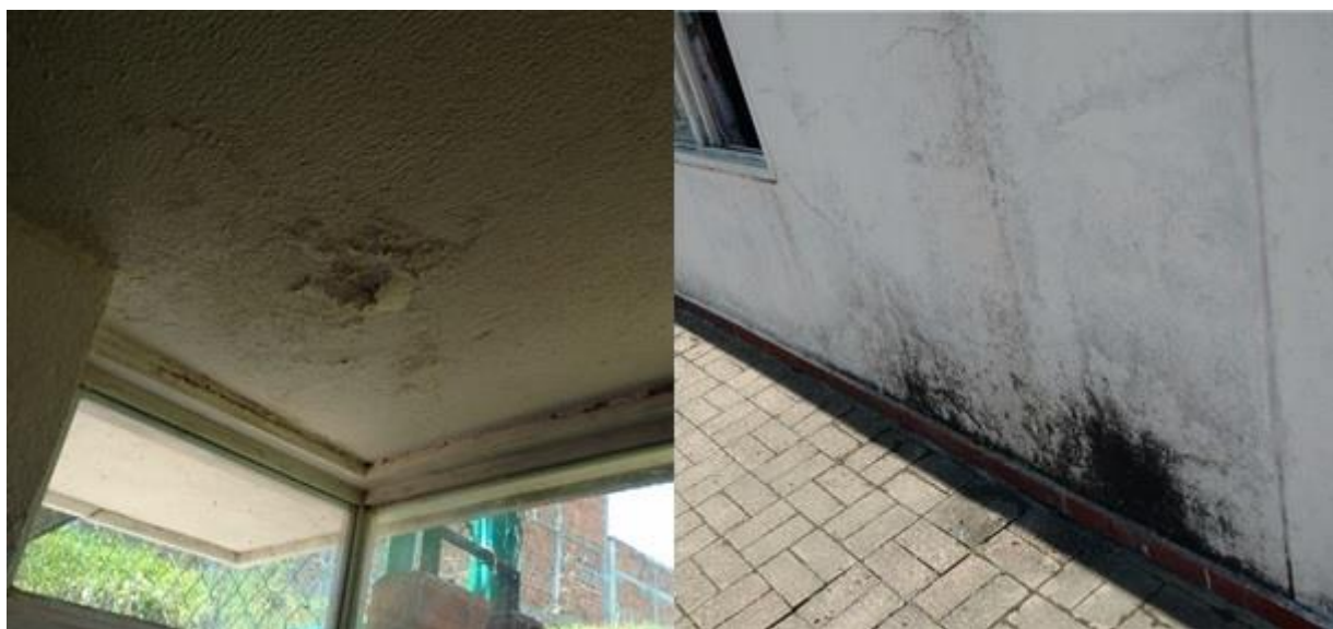
Figura 8. Pañete deteriorado sobre placa y muro
