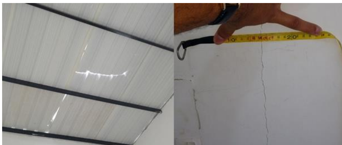
Figura 30. Estado de la infraestructura del centro de atención y reparación a víctimas
