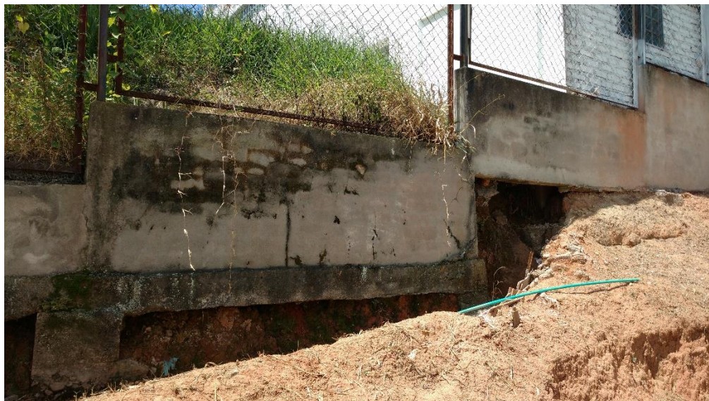
Figura 10. Remoción de material por arrastre de aguas lluvia
