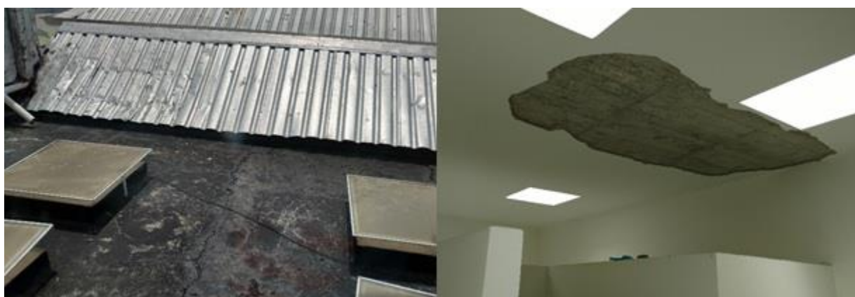
Figura 23. Pañete afectado por filtración de agua
