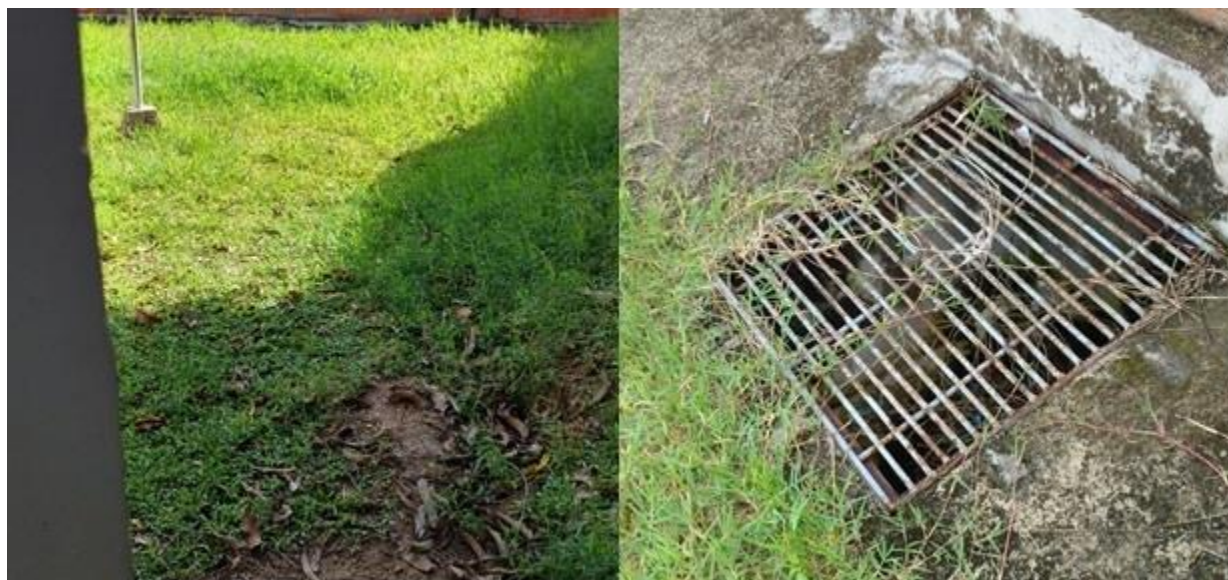
Figura 21. Localización de tubo conductor de aguas lluvias a caja de inspección
