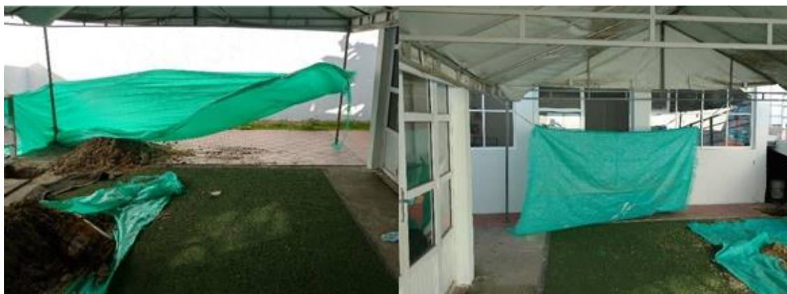
Figura 75. Cerramiento inadecuado en excavación de zapatas (S. Comunitario Cebollitas)
