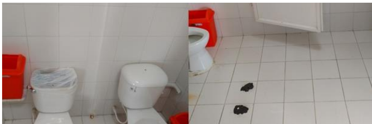
Figura 25. Daños en unidades sanitarias
