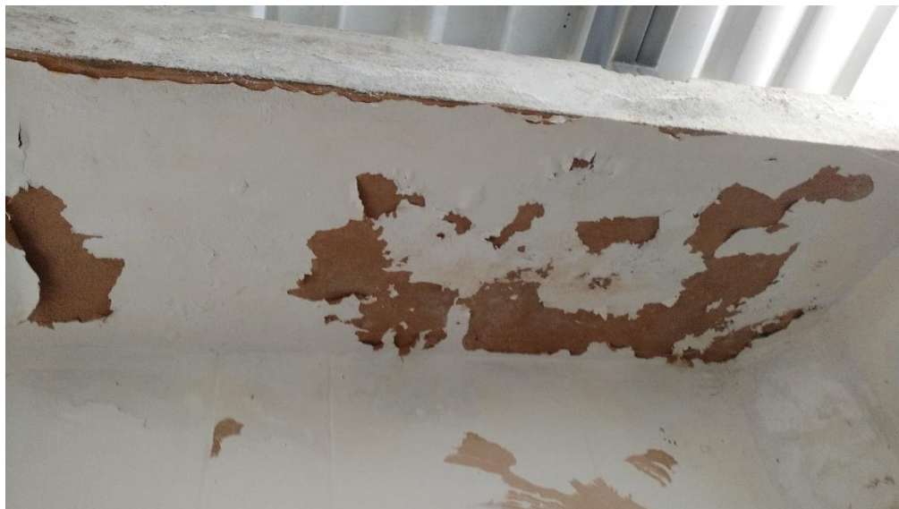
Figura 14. Viga canal afectada por filtración de aguas lluvia
