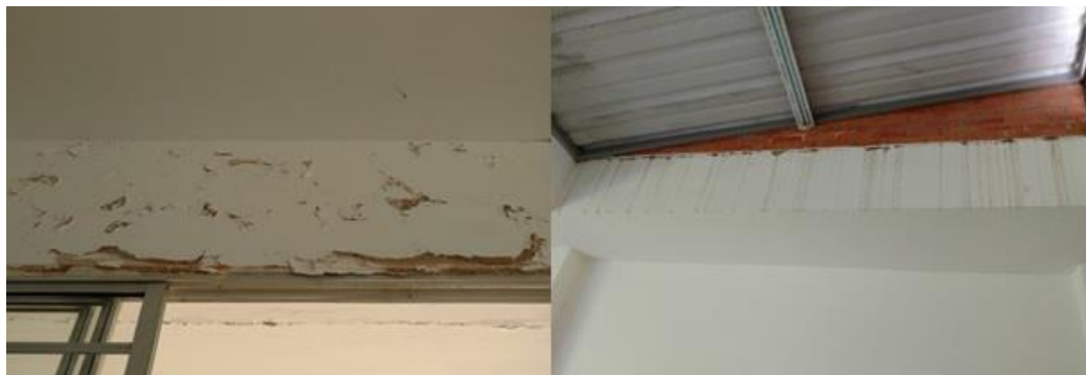
Figura 18. Parte interior de aulas afectadas por aguas lluvia
