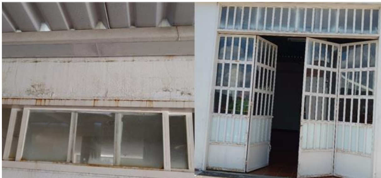
Figura 9. Marcos y puertas metálicas en mal estado
