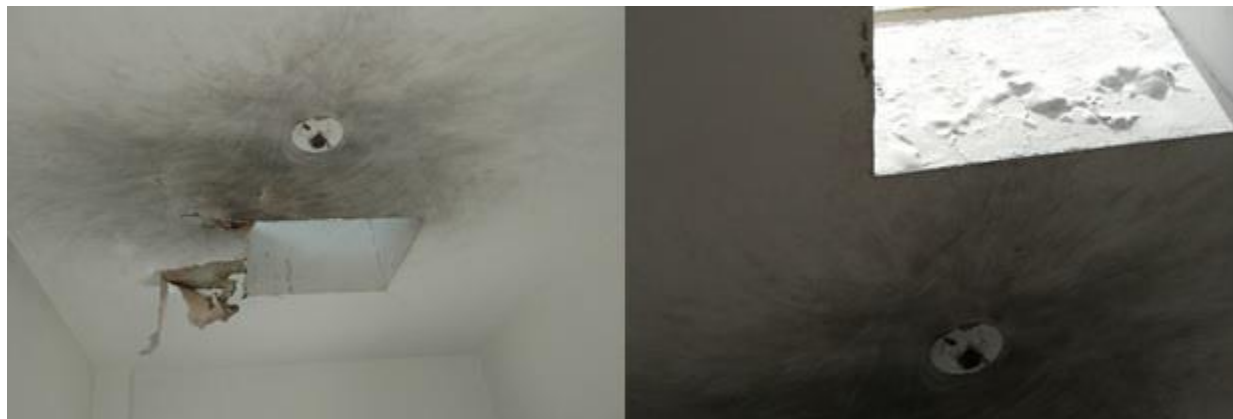
Figura 24. Mal funcionamiento de los tragaluces
