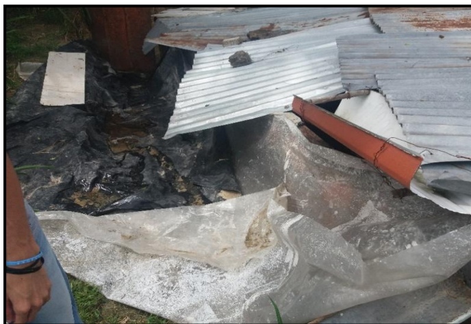
Figura 48. Manejo inadecuado de las aguas de esorrentía por parte de la vivienda 7 en la corona del talud #1.
