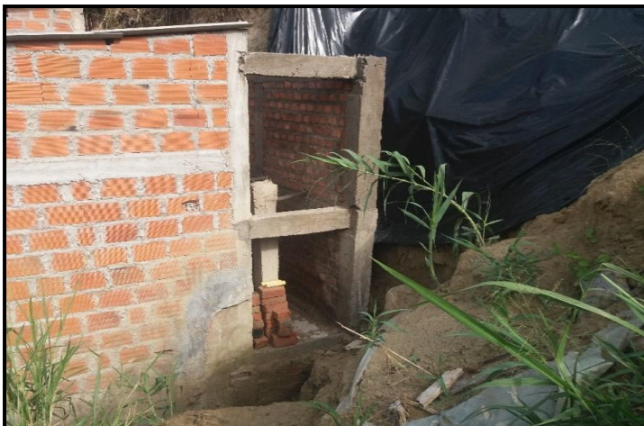
Figura 461. Muro en mampostería doble construido por la comunidad en el talud estudiado. Fuente. Autores del proyecto
