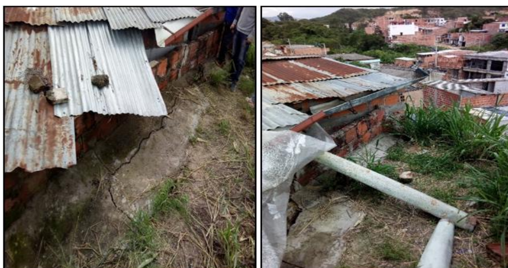
Figura 45. Grieta ubicada entre la vivienda y la corona del talud #1. Fuente. Autores del proyecto
