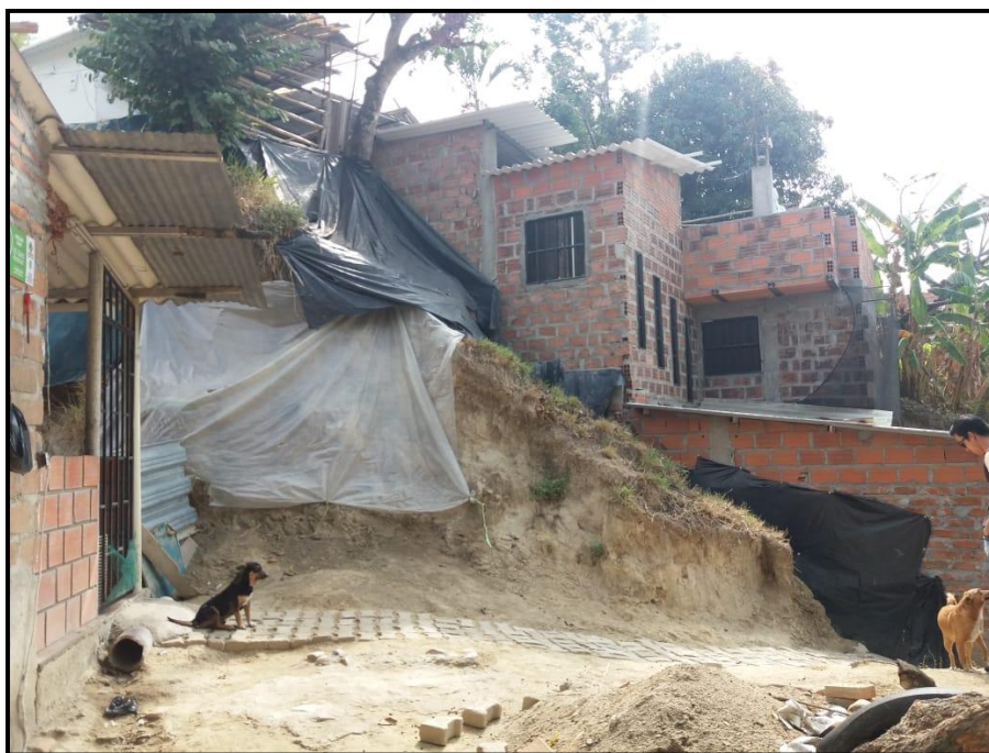
Figura 25. Talud #3, parte del talud que genera problemas a las viviendas.
