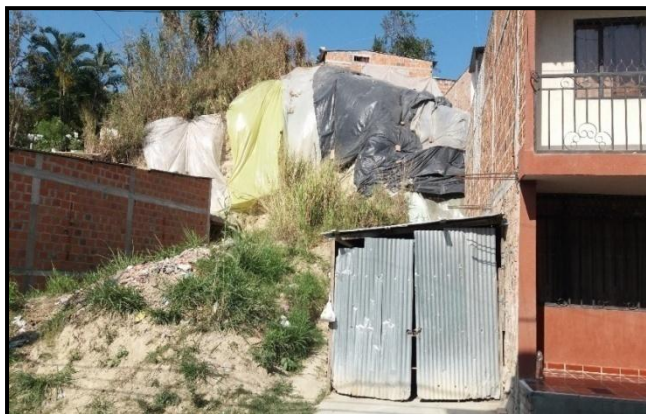
Figura 40. Talud #1- material deslizado después de ocurrido el fenómeno de remoción en masa del 2015. Fuente. Autores del proyecto.
