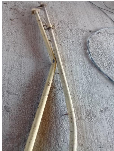
Imagen. 20. Parales metálicos deformados.
