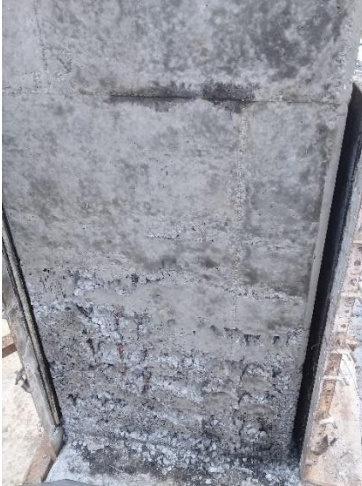
Imagen. 39. Desencofrado de Columnas, muestra de imperfecciones.
