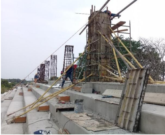
Imagen. 30. Anclaje de Columnas con parales metálicos.
