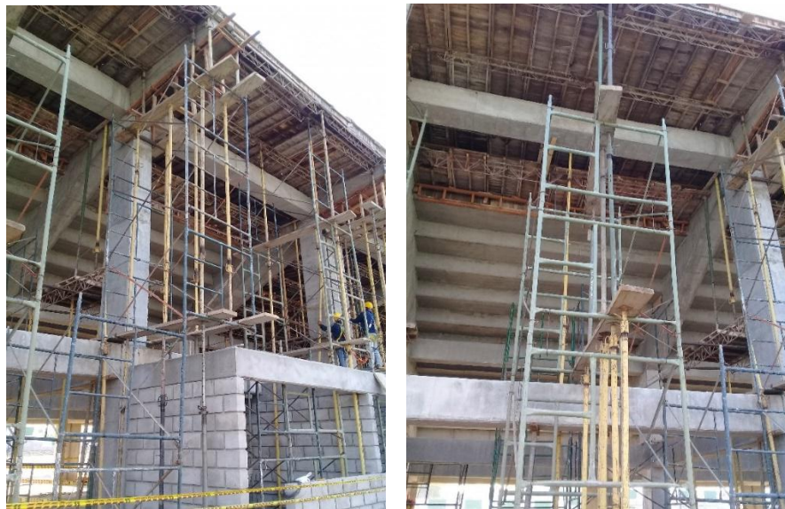
Imagen. 23. Nuevo sistema de obra falsa con uso de andamios y tablonés de madera.
