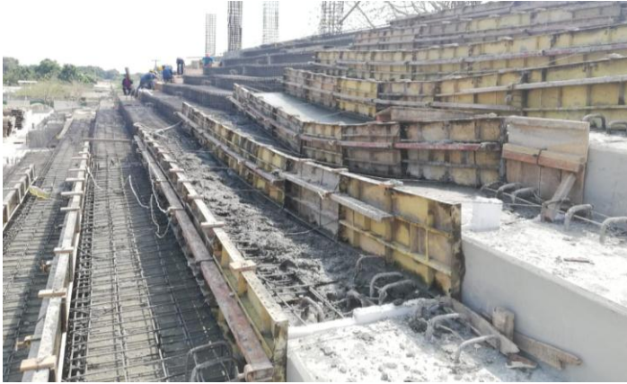
Imagen. 18. Hundimiento de graderías por falla en los parales metálicos.
