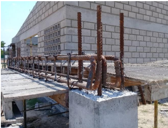
Imagen. 51. Armado de acero de refuerzo de viga de pórtico A, rampa Norte.
