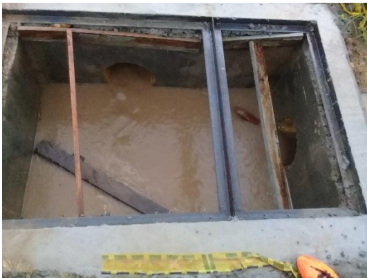
Imagen. 229. Trampa de arena en funcionamiento.
