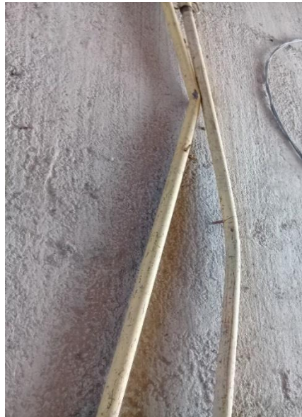
Imagen. 21 Parales metálicos deformados.
