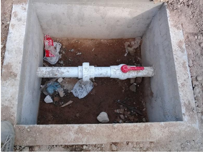
Imagen. 104. Caja para válvula desaireadora y válvula solenoide.
