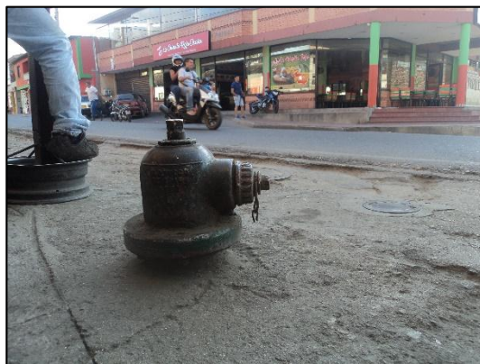
Figura 35. Hidrante de la calle 11 con carreta 28 Fuente. Autores
