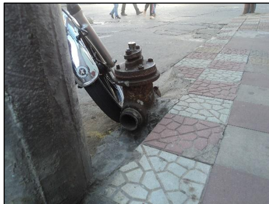
Figura 34. Hidrante de la Calle 7 con Carrera 20 Fuente. Autores
