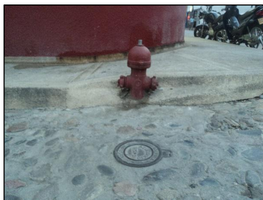
Figura 25. Hidrante en la calle 11 con carrera 7 Fuente. Autores
