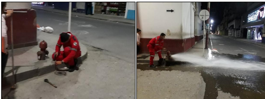
Figura 12. Revisión del estado del hidrante de la calle 11 con carrera 11. Fuente. Autores
