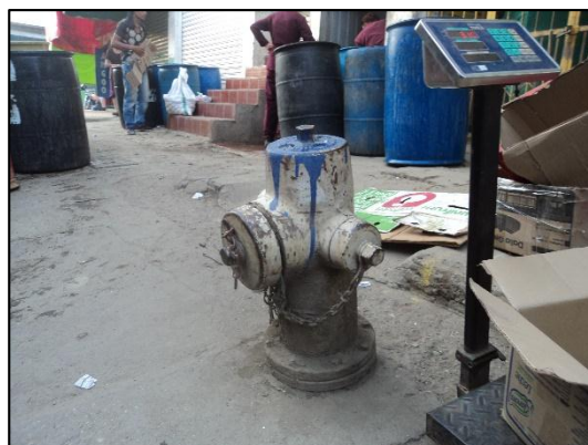
Figura 36. Hidrante de la calle 7 con carrera 14 Fuente. Autores
