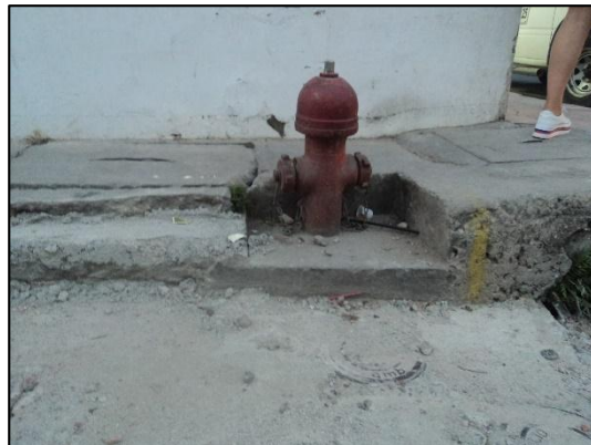
Figura 24. Hidrante en la calle 10 con carrera 11 Fuente. Autores
