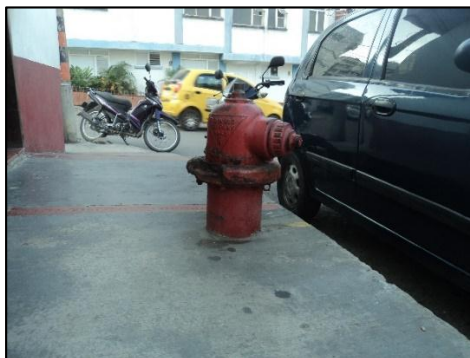
Figura 44. Hidrante oxidado de la calle 12 con carrera 14 Fuente. Autores
