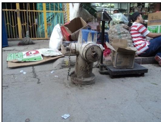
Figura 46. Hidrante con válvula en regular estado Fuente. Autores
