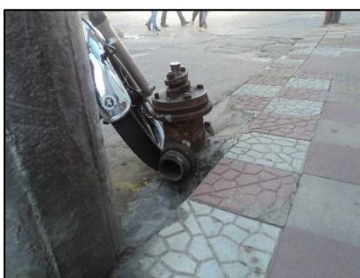
Figura 43. Hidrante fuera de funcionamiento de la calle 7ª con carrera 20 Fuente. Autores
