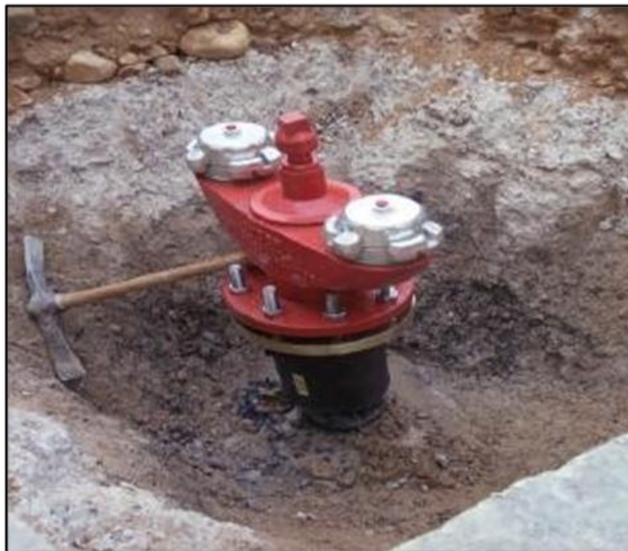
Figura 5. Hidrantes enterrados bajo el nivel del terreno. Fuente. Alcarraz Fernández E. (2014).
