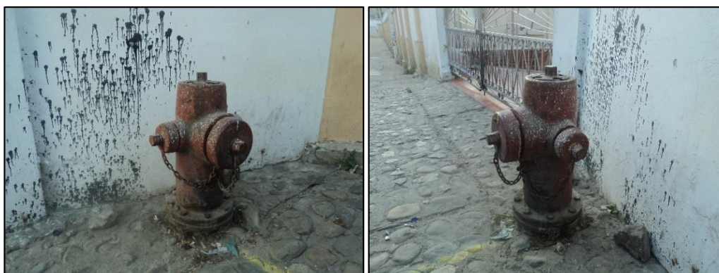
Figura 30. Hidrante del barrio Cementerio Central sobre la calzada. Fuente. Autores
