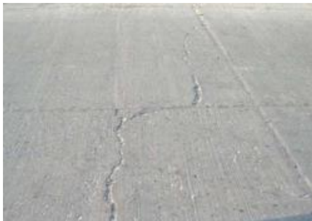
Figura 8. Grieta transversal del pavimento rígido Fuente: INVIAS
