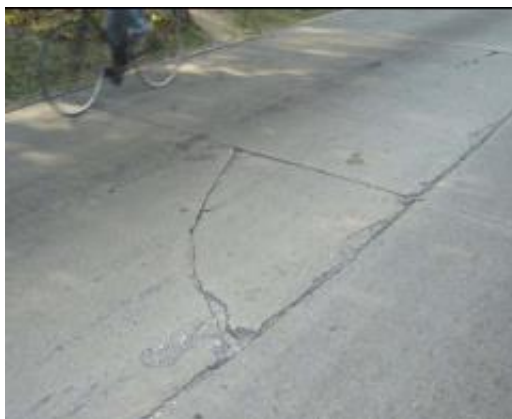
Figura 6. Grieta de esquina del pavimento rígido Fuente: INVIAS.
