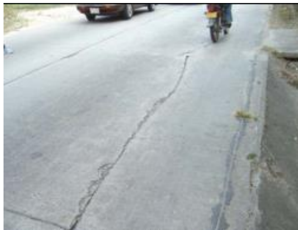
Figura 7. Grieta longitudinal del pavimento rígido. Fuente: INVIAS
