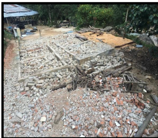
Figura 7. Tanques, Tinas y Sedimentadores
