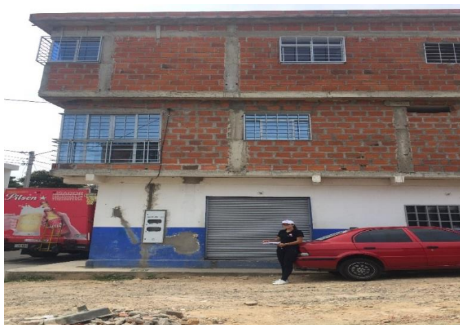
Figura 6 Vivienda con irregularidad vertical, sistema en voladizo. Fuente: Autores.
