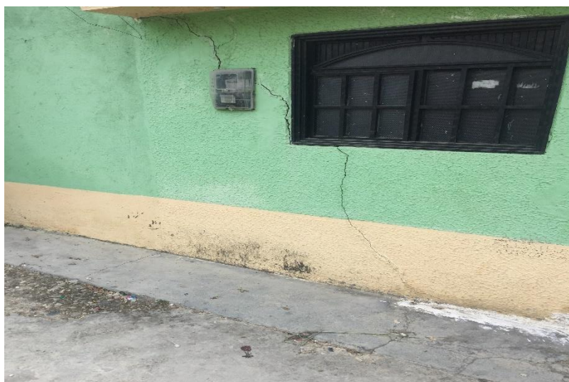
Figura 5 Vivienda con ruptura de falla de superficie.
