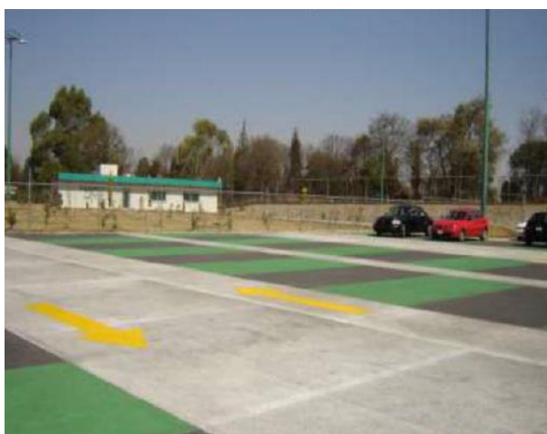
Figura 30. Pavimento poroso en la planta Schnyder Electric en Tlaxcala, México Fuente: Castro, 2011. Pavimentos permeables como alternativa de drenaje urbano . p. 71
