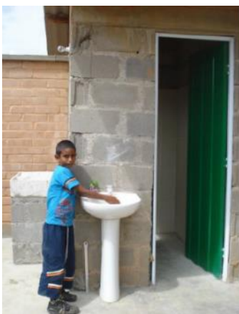
Figura 38. Baño hecho con bloques de cemento en vivienda fabricada con BTC para evitar daños por humedad. Obtenido de: proyecto CASA VIVA.
