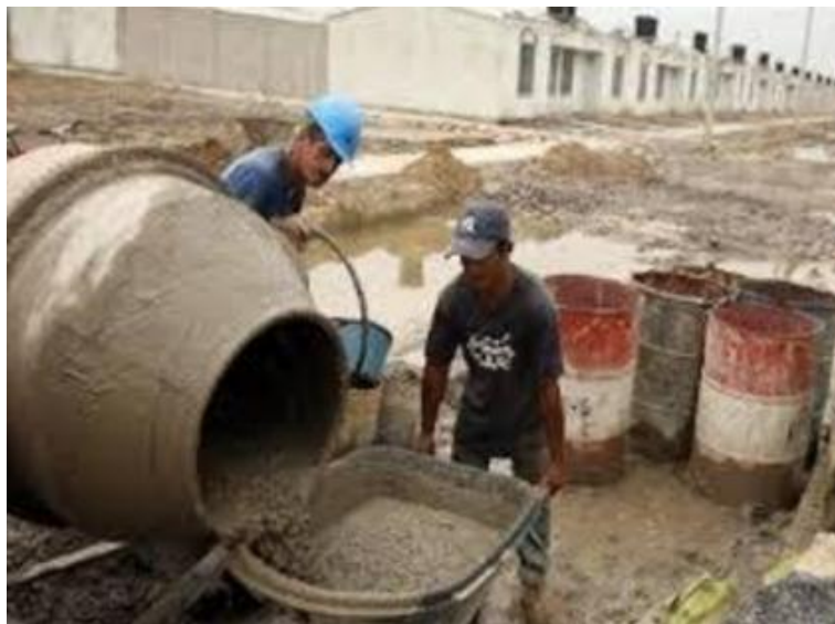
Ilustración 10. Mezcladora de mortero y hormigón.
