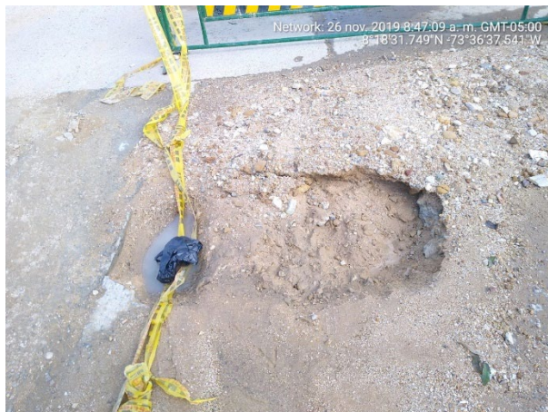
Figura 26. Excavación para controlar fuga, pendiente por reparar.
