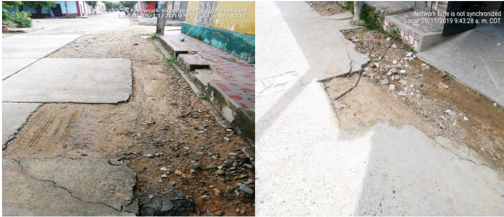
Figura 29. Reparación de pavimento pendiente por realizar.
