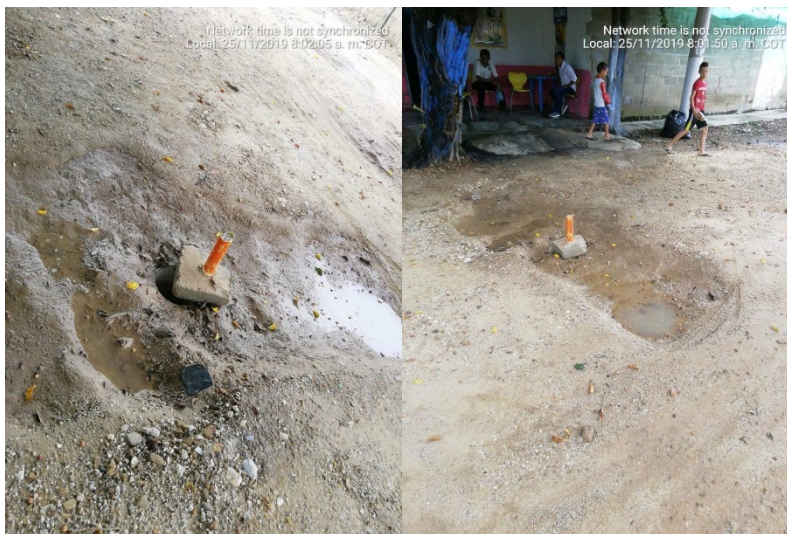
Figura 25. Válvula sin su respectiva tapa.
