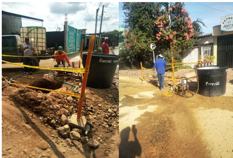
Llenado de la tubería con la bomba de pistón y agua potable
