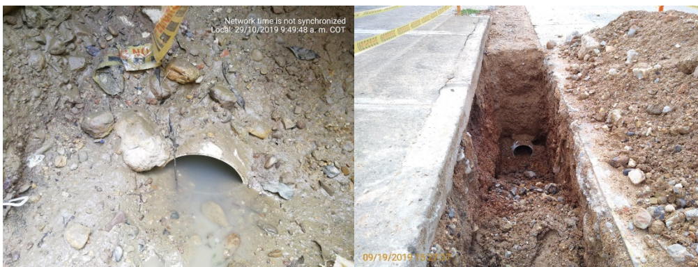
Figura 24. Boca de tubo sin la respectiva protección
