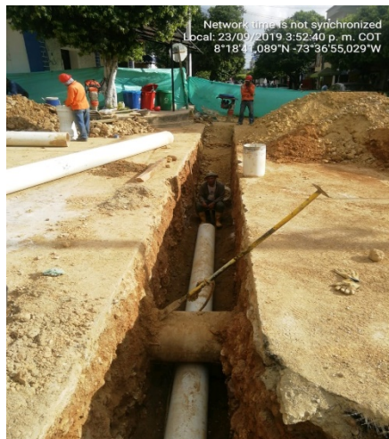
Figura 21. Tuberías de acueducto en la misma zanja de una tubería de alcantarillado
