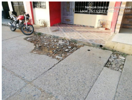
Figura 30. Reparación de pavimento pendiente por realizar.
