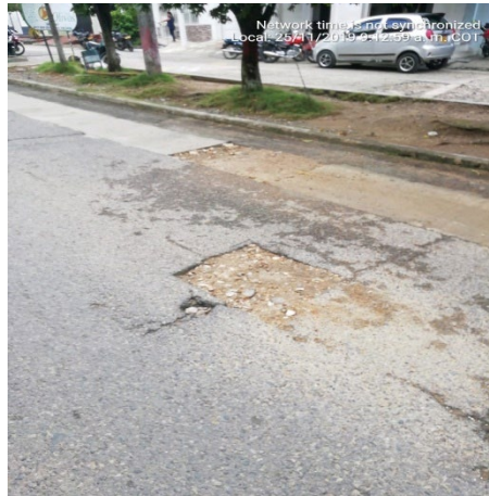
Figura 28. Reparación de pavimento pendiente por realizar.
