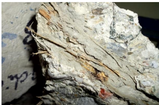
Figura 6. Mezcla de concreto con fibra de bagazo de caña presentando mala adherencia.
