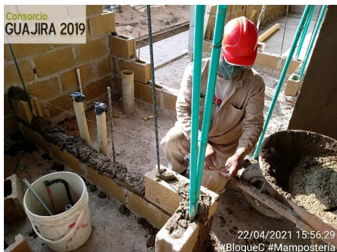
Figura 9. Tubería eléctrica intramural. Fuente: pasante
