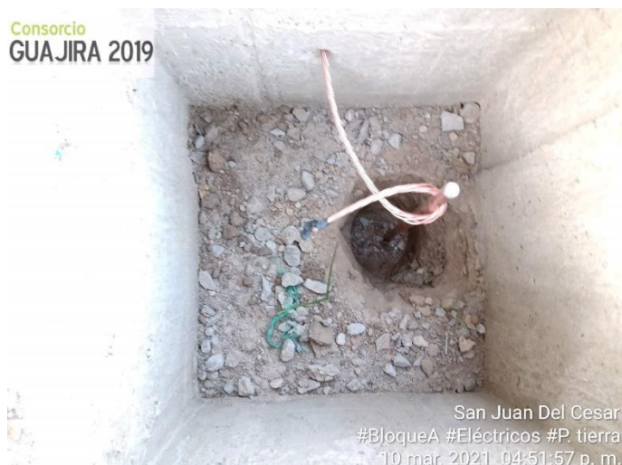
Figura 21. Caja puesta a tierra. Fuente: pasante
