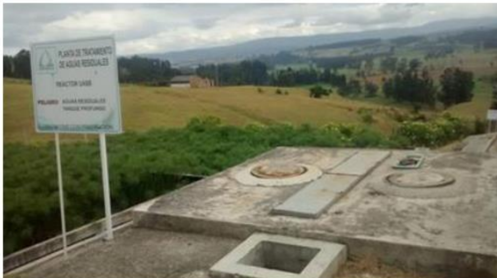
Figura 32. Reactor anaerobio de lecho de lodos con flujo ascendente. (2018) Obtenido de:
