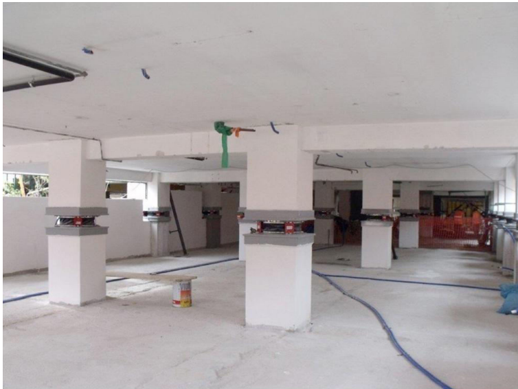
Aisladores sísmicos empleados en el edificio Bridgestone Toranomon
