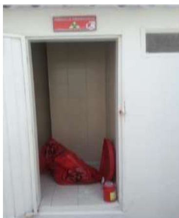
Foto 17. Cuarto de residuos peligrosos
