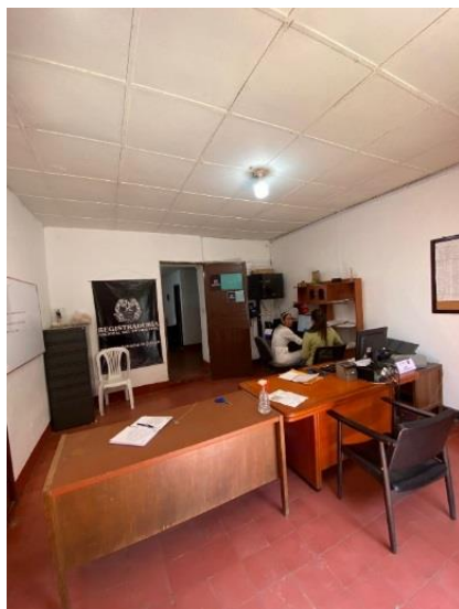
Figura 33. Sistema de iluminación LED, Oficina de Registraduría Municipal de La Playa
