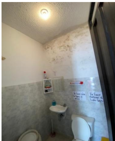
Figura 30. Sistema de iluminación bombillo halógeno, Registraduría Municipal de Abrego
