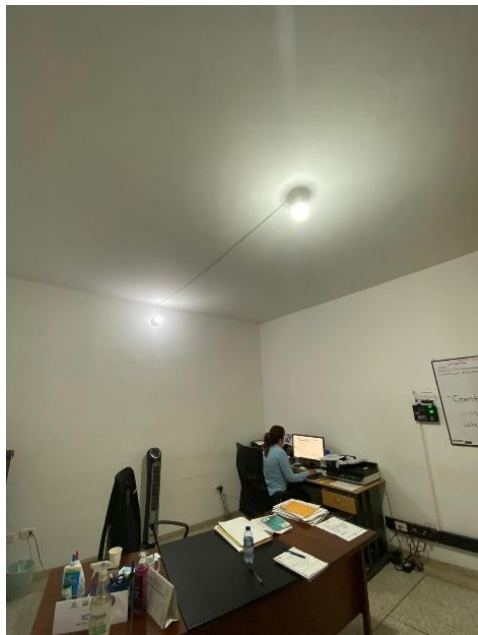
Figura 29. Sistema de iluminación LED doble, Oficina de Registraduría Municipal de Ocaña
