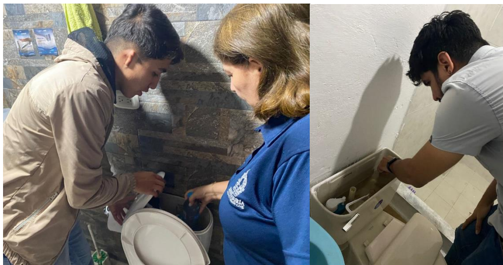
Figura 78. Instalación de Botellas de agua en los Tanques de Almacenamiento de los Inodoros
