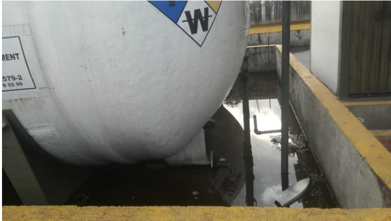
Ilustración 32. Zona de combustibles Patio de Talleres.
