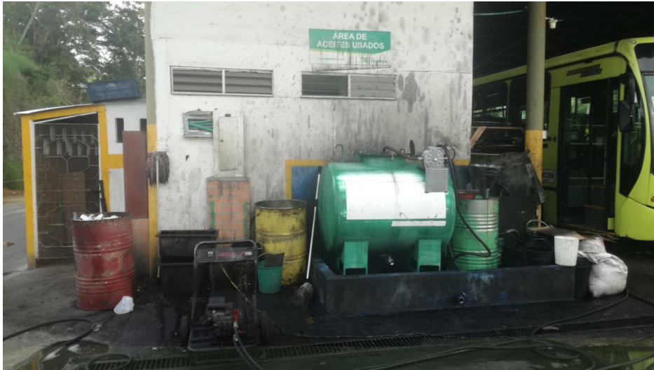
Ilustración 34. Acopio de aceites usados Movilizamos S.A.
