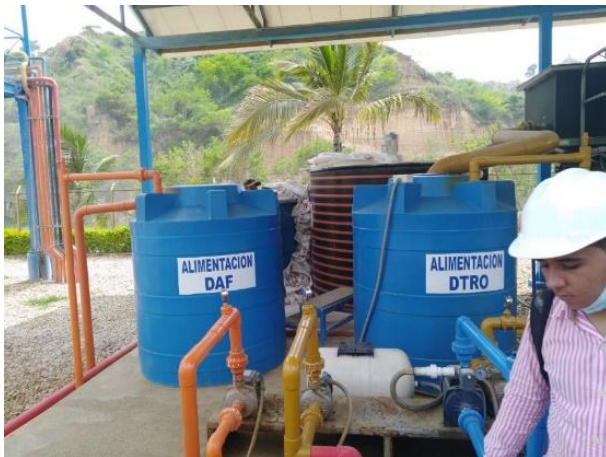
Ilustración 21. Zona de Bombeo de lixiviados Planta de Tratamiento de Lixiviados.
