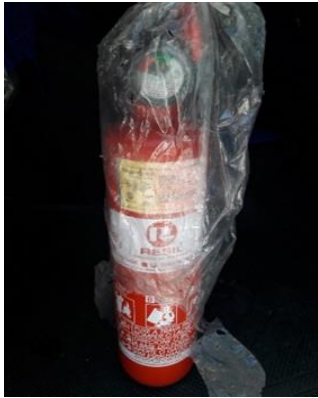
Ilustración 9. Extintor 3 Furgón WFQ649.
