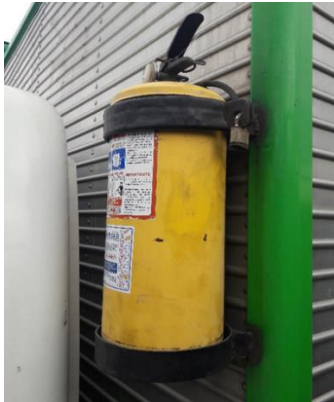
Ilustración 3. Extintor 1 del Furgón UFZ065.
