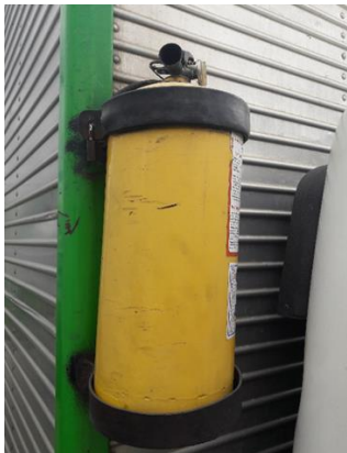
Ilustración 4. Extintor 2 del Furgón UFZ065.
