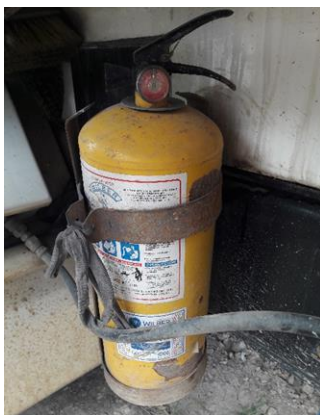
Ilustración 13. Extintor 2, Succión WFL385.
