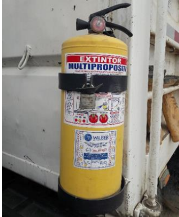
Ilustración 23. Extintor 2 Volqueta UPO331.
