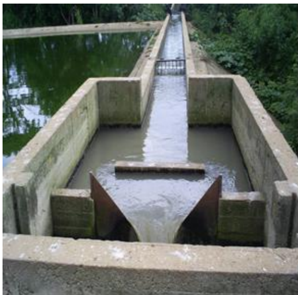
Figura 5. Recamara de entrada de aguas residuales a la laguna de oxidación. Contraloría general del departamento de Norte de Santander (2013).
